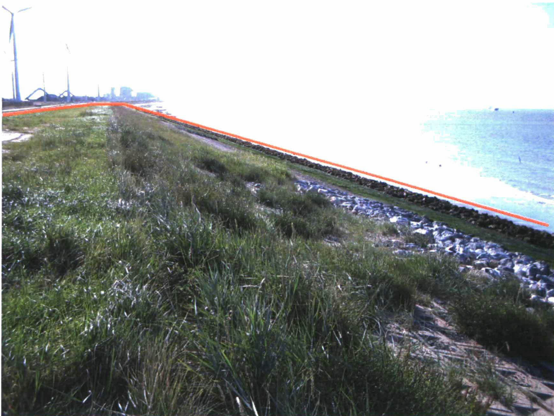
Westelijk deel zwakke zeewering aanbevolen reparatievak naar het oosten gezien
