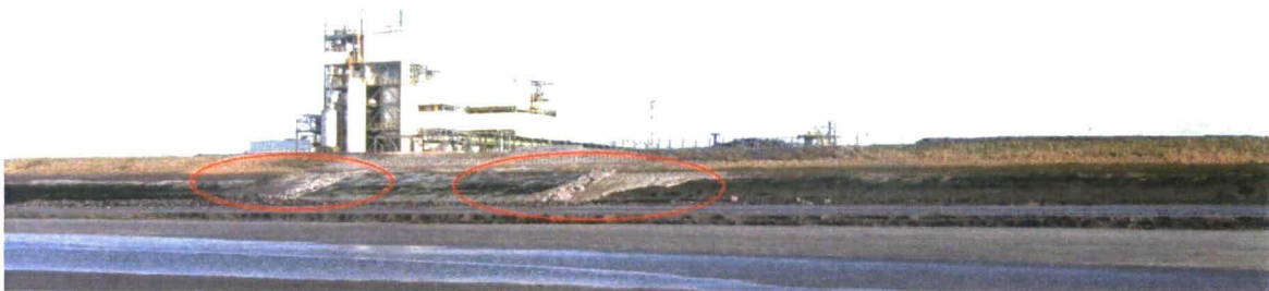
Dijkvak met verzwakte en deels gerepareerde stukken bij Arkema
