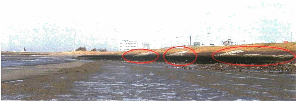
Dijkvak met verzwakte en deels gerepareerde stukken
