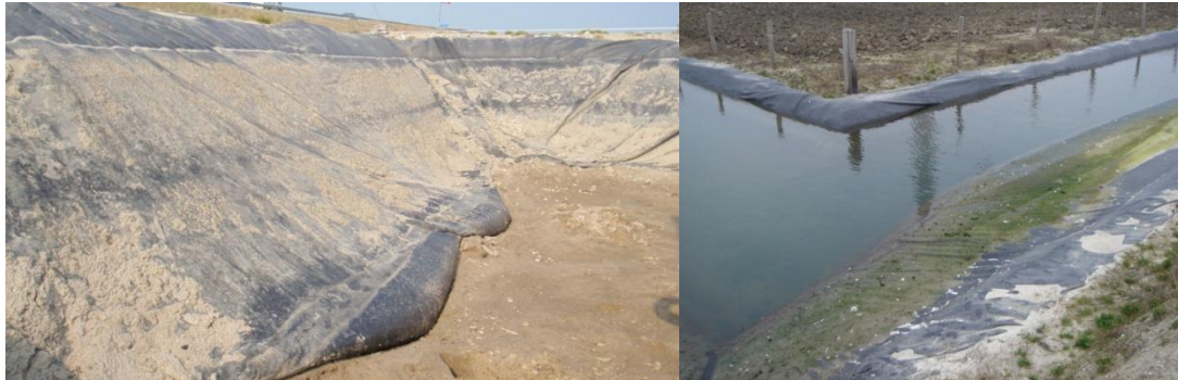
Figuur 14. Ophoping van grondwater achter de folie van een droogstaande vijver (li) en (re) achter de folie van de ringsloot.
