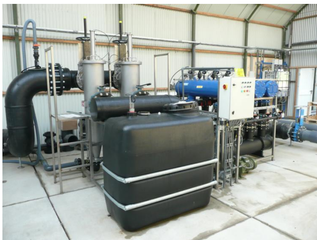
Figuur 6. Overzicht van het filtersysteem met links twee verticale grof filters en rechts vier horizontale fijn filters. Het vat op de voorgrond dient als opslag voor gefilterd water om de filters te spoelen.
