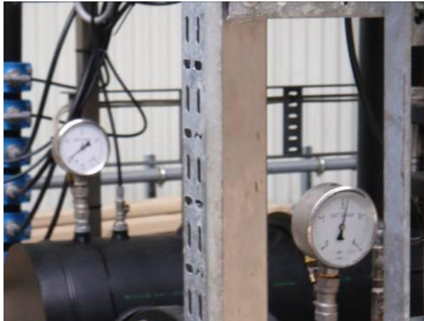
Figuur 8. Drukmeting over een verstopt fijnfilter (storingmelding tijdelijk overruled). Manometer op de voorgrond geeft de druk weer voor het filter (2.1 bar). Manometer op de achtergrond geeft de druk na het filter weer (0.05 bar).
