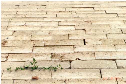
Figuur 13.5: Gekantelde betonblokken
