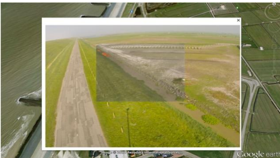
Figuur 5.2 Infrarood camera detectie van uittredend kwelwater, infrarood foto is over visuele foto geplaatst. Rode vlek geeft (significant) temperatuurverschil aan in slotwater – indicatie van uittredend kwelwater
