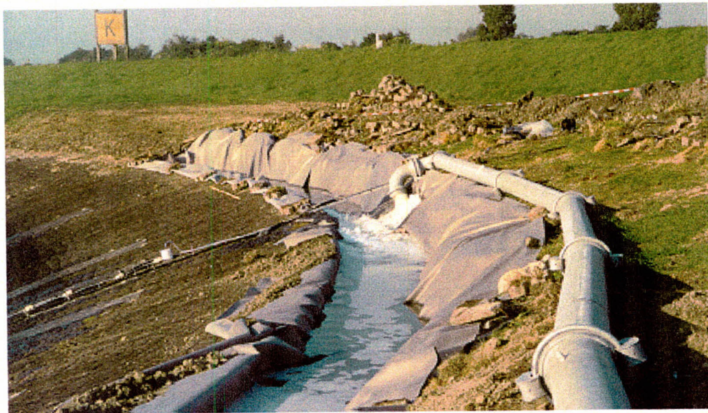
Infiltratiesloot met toevoer van water
