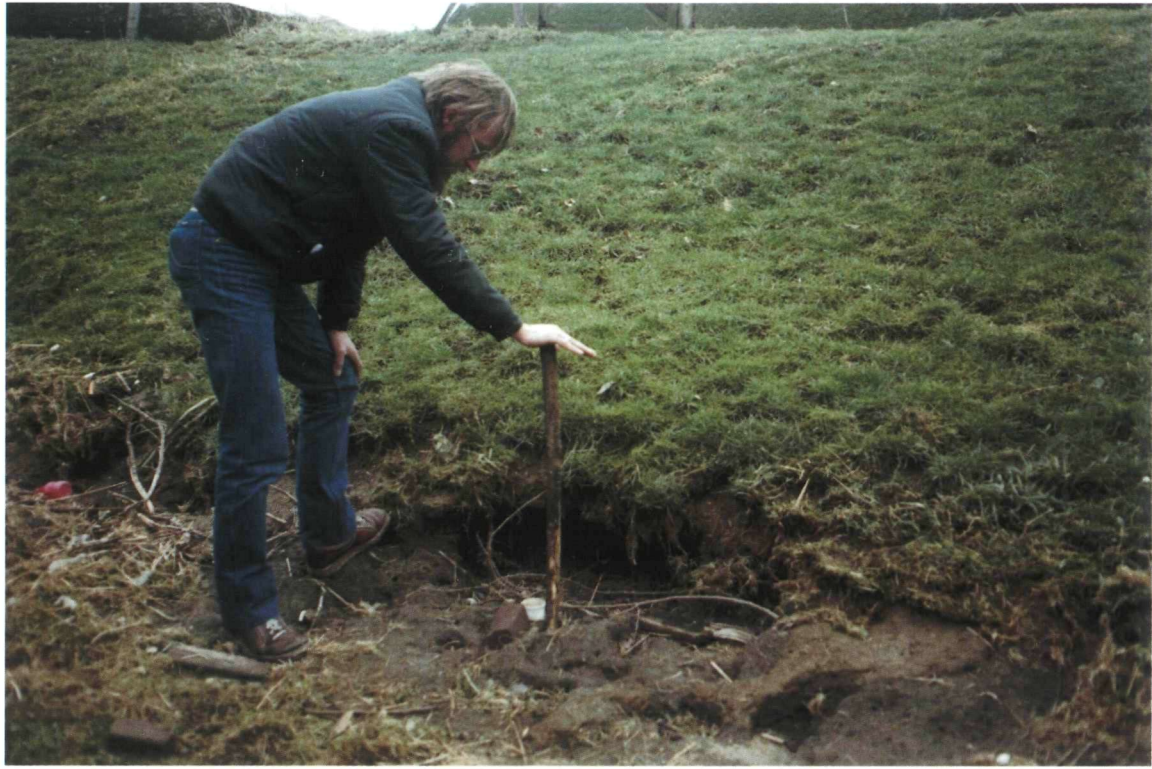
1.1a: Beschadiging van het buitentalud van een dijk door uitspoeling, mogelijk naar aanleiding van graverijen. [RWS-DWW 214/33a]
