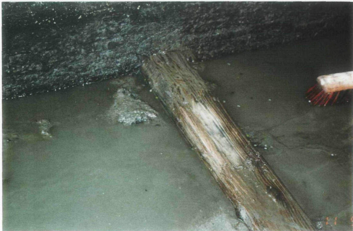
3.6c: Weggerotte houten vloerconstructie, inlaat Westbeer. De inlaat is in verband met inspectie drooggezet. Ondergrond bestaat uit klei, zodat dit geen gevolgen behoeft te hebben met betrekking tot piping. [Grontmij].
