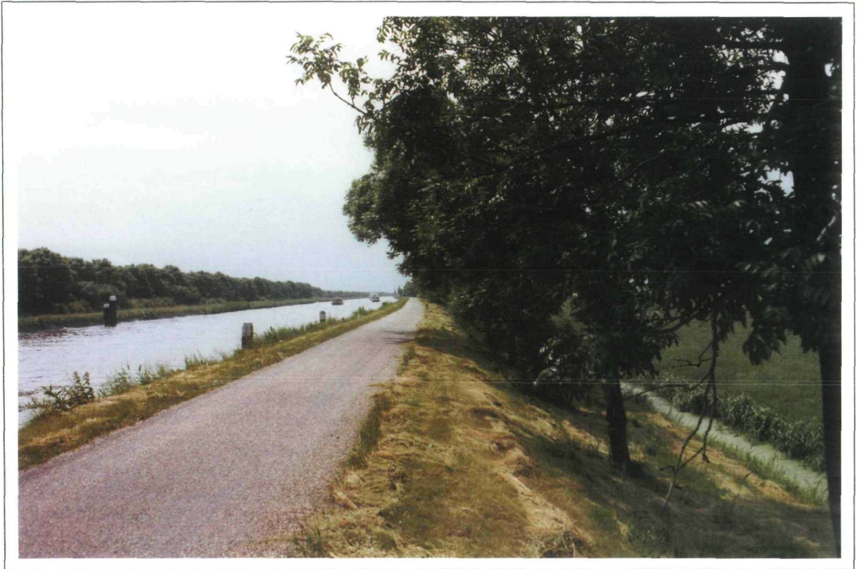
1.4a: Bomen op het binnentalud in kade langs de Gouwe (boezemkade). Feitelijk is hier nog geen sprake van schade. Wel is de conditie van de bomen van belang. [RWS-DWW 121/15]
