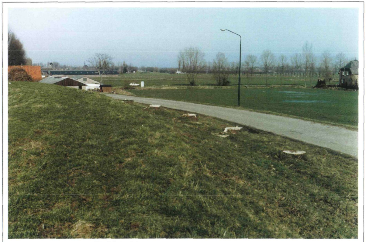
1.4b: Afgezaagde bomen op het binnentalud van de Megensedijk (Maasdijk). Zowel het verwijderen van de stronk als het laten zitten is een risico. Mogelijk leidt dit in de toekomst tot ongewenste gangvorming t.p.v. de oorspronkelijke wortels. [RWS-DWW 323/18a]
