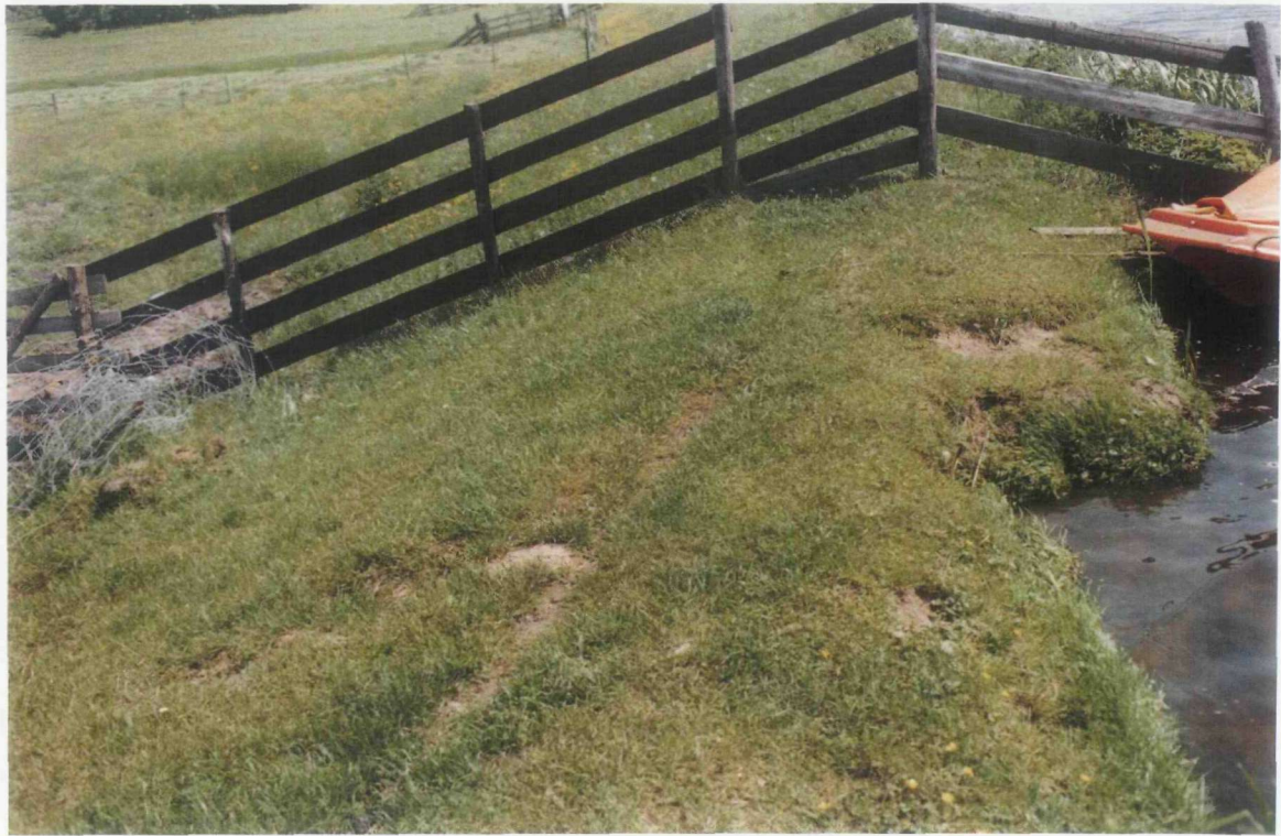
1.3 a: Afkalving van het buitentalud ter plaatse van een aardgasleiding, Kromme Does (boezemkade). [RWS-DWW 117/24a]
