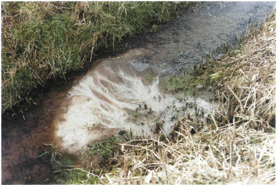
2.10: Zandmeevoerende wel in de sloot aan de teen van de Maasdijk te Lage Zwaluwe, in combinatie met een verzakt binnentalud. [RWS-DWW 128/23]
