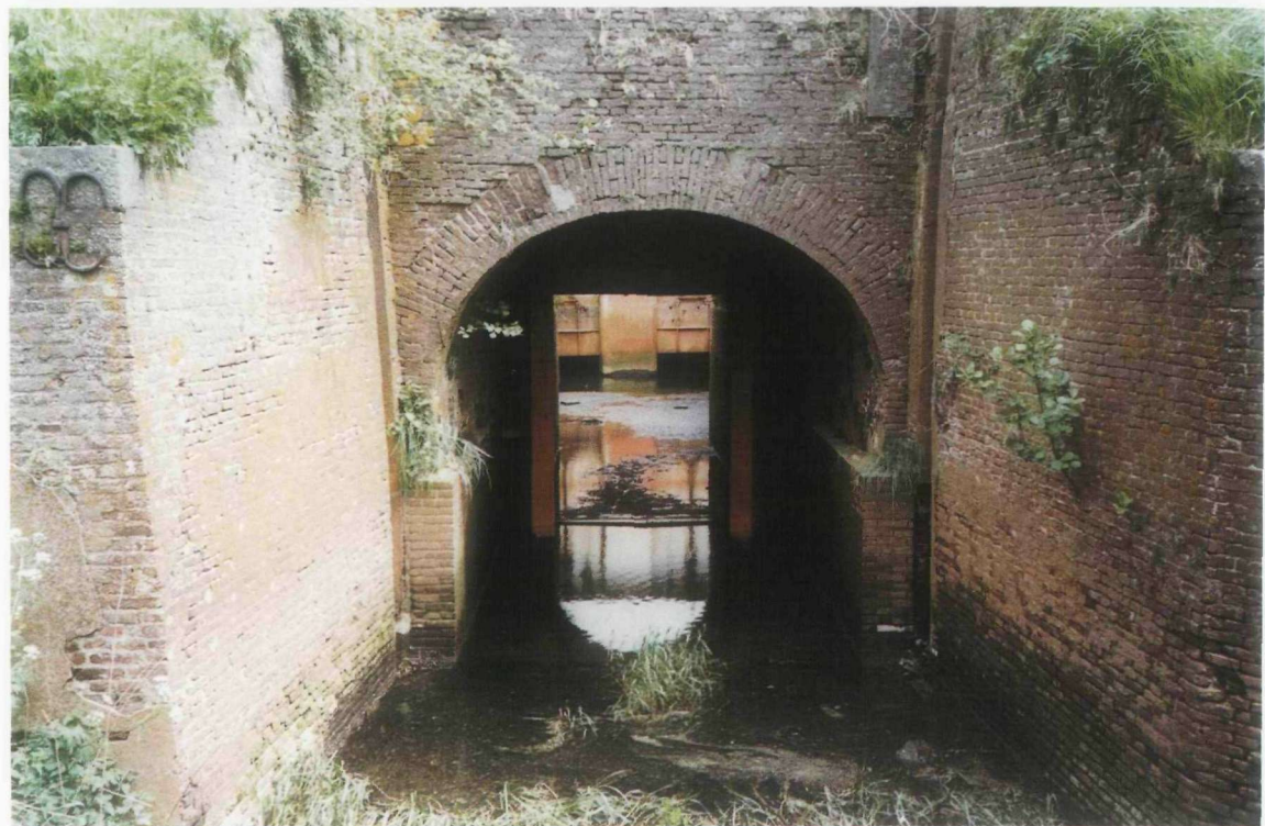
3.6d: Begroeiing uit vleugelwanden ter plaatse van instroomopening van een keersluis. Aan de waterdichtheid van de vleugelwanden kan worden getwijfeld. De ernst hiervan hangt af van de functie die de vleugelwanden moet vervullen t.a.v. piping. [Fugro].
