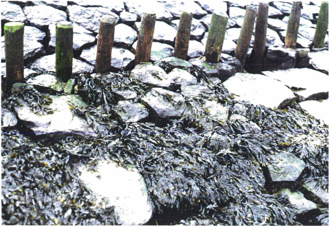
Foto 11 Reparatie van schade in Doornikse steen direct naast het te toetsen vak (Rijksdijk).
