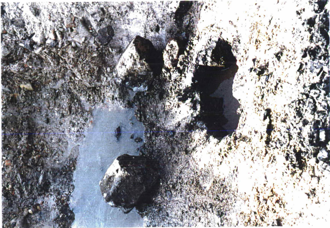
Foto 7 Gat in het talud onder het zand. Links stroomt het gat in het voorland vol met water, in het gat in de bekleding is water gegoten; dit stond droog.
