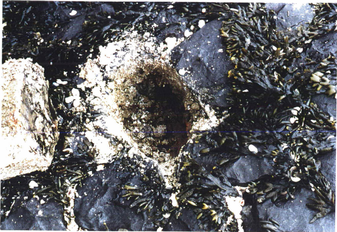
Foto 13 .Gat in de basalt midden in het talud onder de perkoenpalenrij bij dp 93.
