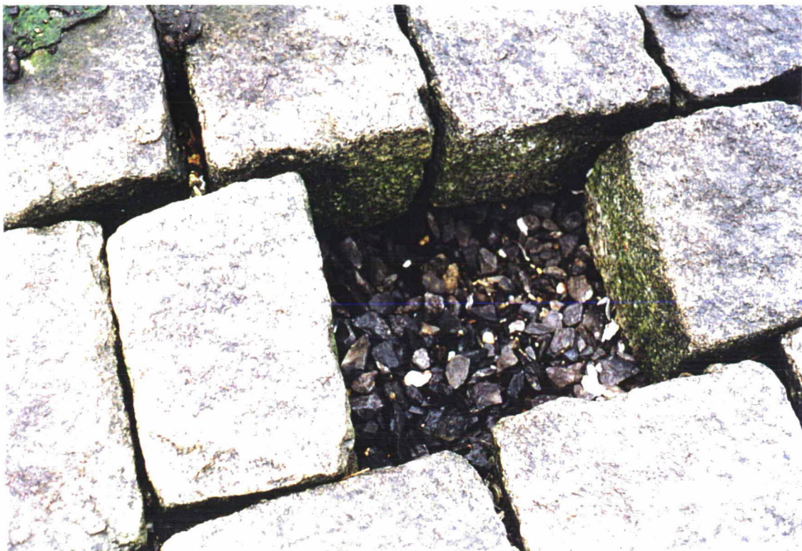
Foto 7 Gat in de bekleding bij dp 259 + 70 m.
