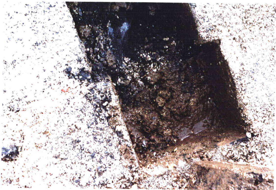
Foto 8 Gat in de koperslabblokken laag op het talud bij dp 94. Het filter bestaat uit steenslag dat volledig is dichtgeslibd.
