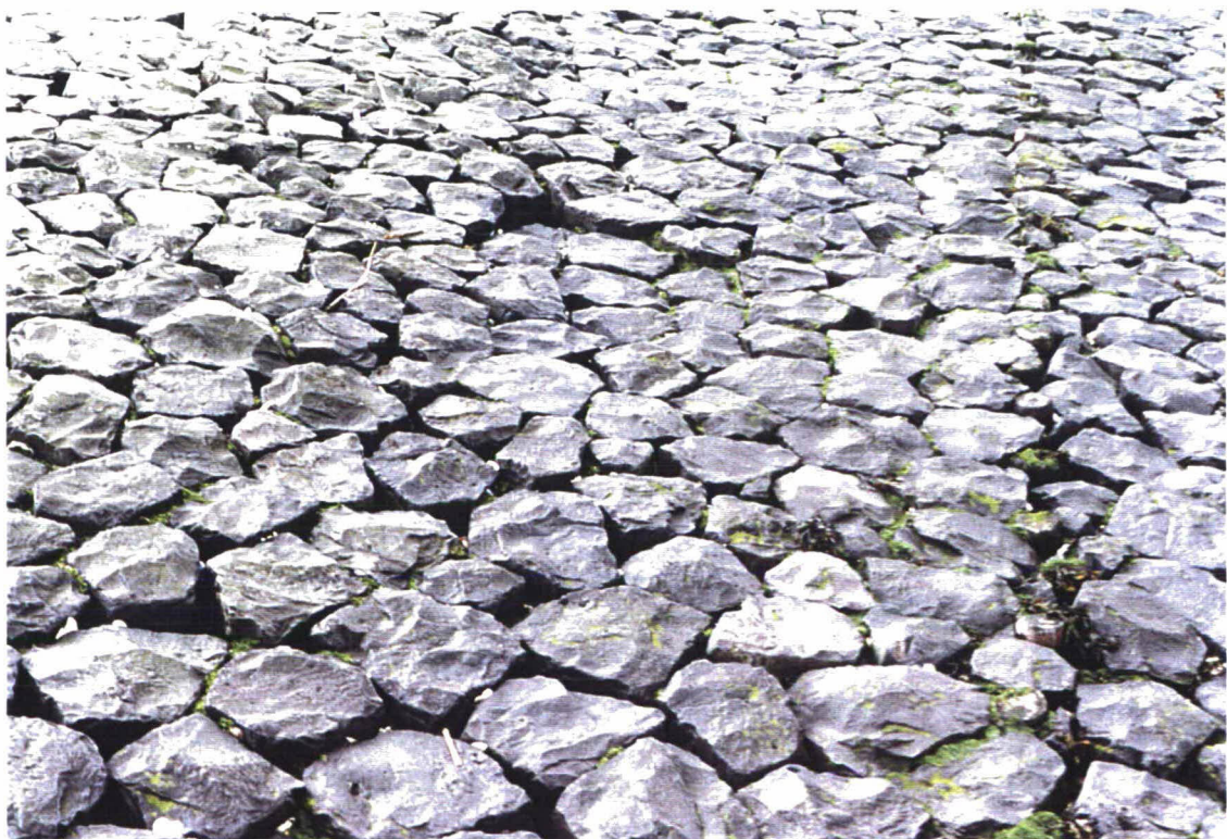
Foto 10 Verzakking in de basaltbekleding boven de perkoenpalenrij bij dp 91+50
