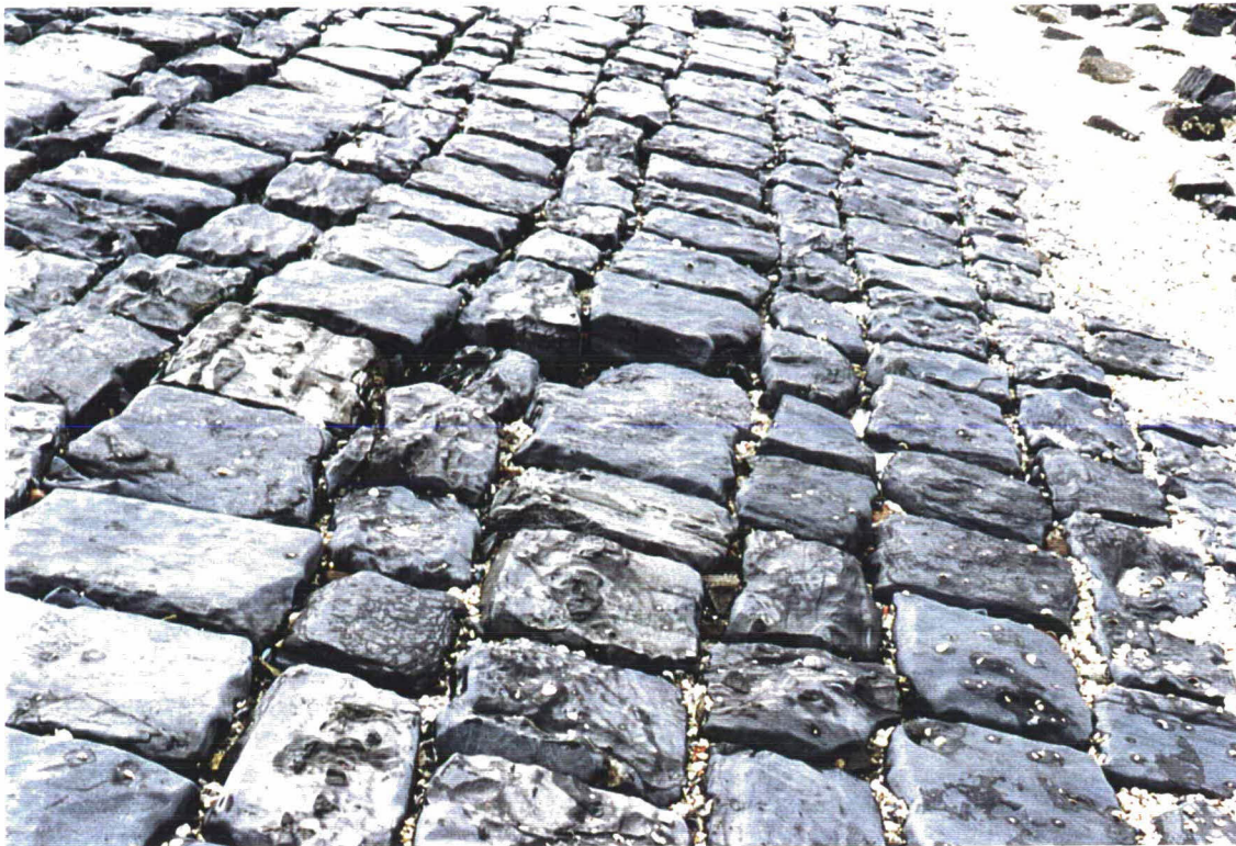
Foto 17 .Op een aantal plaatsen zitten slechte plekken in de bekleding. Deze foto is ongeveer bij dp 86 genomen. Er lijkt een halve steen te missen.
