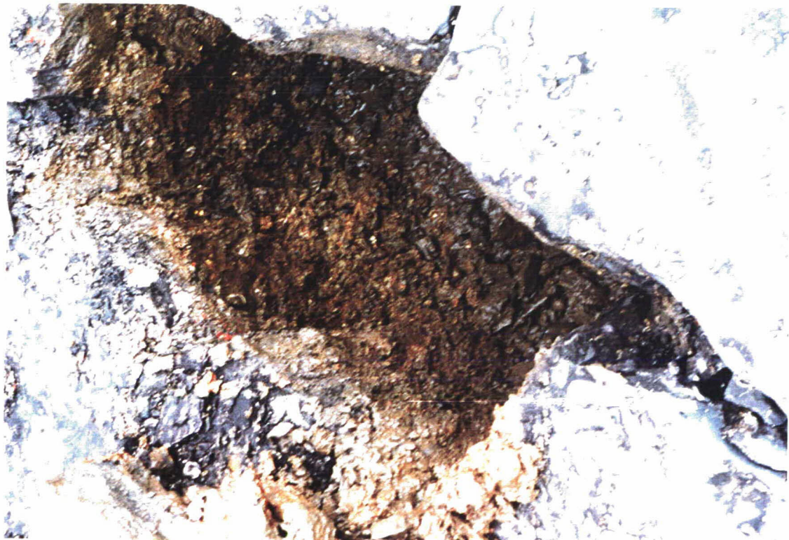
Foto 18 Gat in de Doornikse blokken. Onder de blokken zit een ingezand steenslagfilter.
