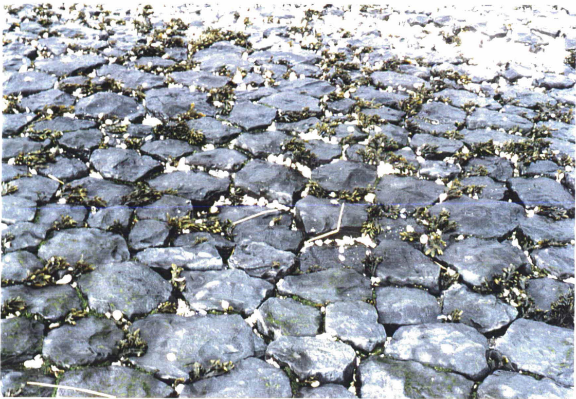
Foto 9 Verzakking in de basaltbekleding boven de perkoenpalenrij bij dp 90
