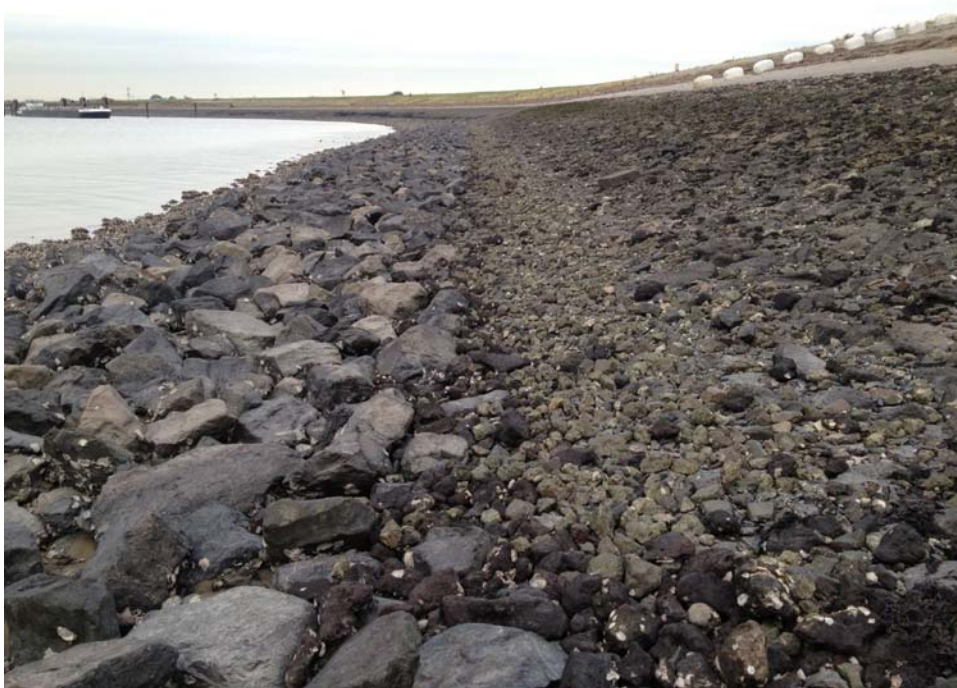
Foto 3.4. Strook losse stenen (gebroken beton) onderaan glooiing, onbegroeid.
