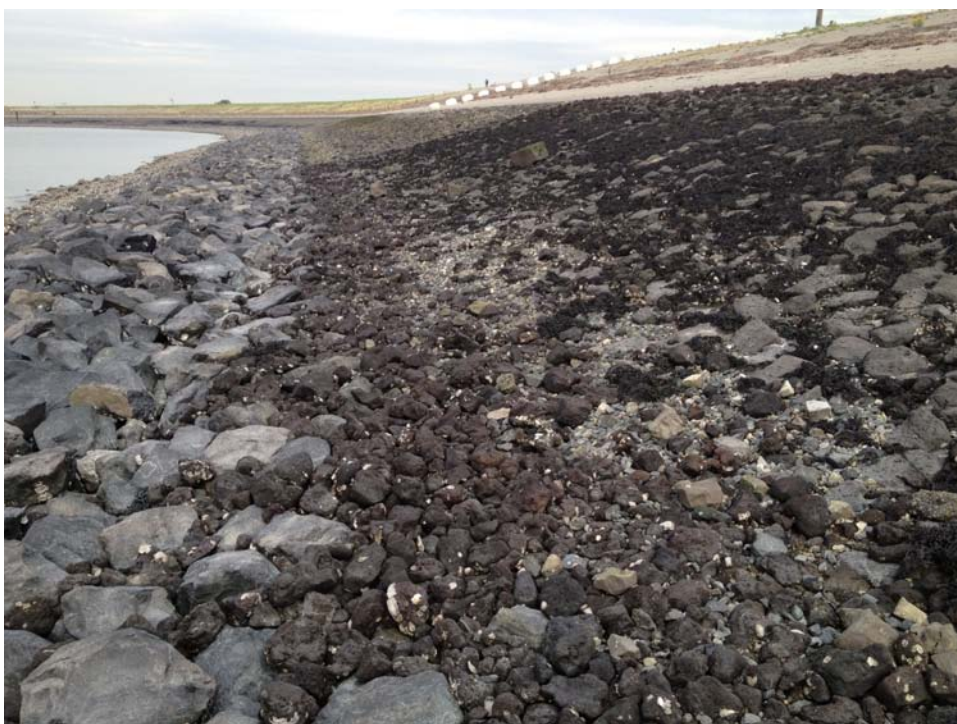
Foto 2.8. Onderaan talud veel losse lavasteen en lokaal ook veel steenslag.
