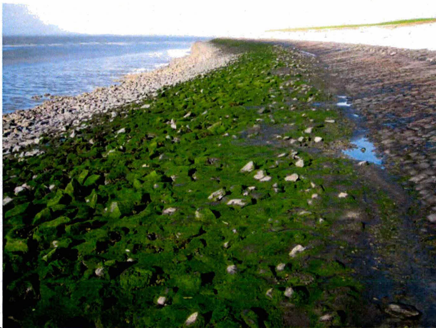
Breksteen met gietasfalt, met "schone koppen". Kruiningenpolder, 2 oktober 2008 (Martien Meijer; Bureau Waardenburg).
