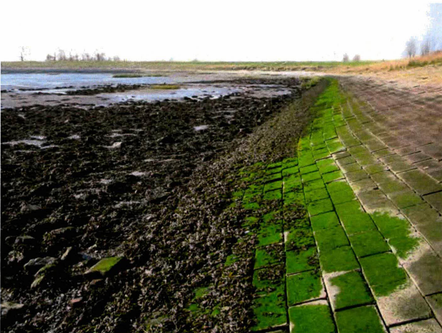
Gekantelde betonblokken. Biezelingsche Ham, 5 november 2008 (Martien Meijer; Bureau Waardenburg).
