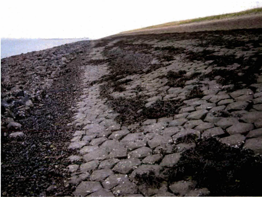
Basalton. Merk op dat de steenslag uitgespoeld is en onderaan de glooiing heen en weer blijft rollen en daarmee begroeiing verhindert. Nabij Hansweert, 7 november 2008 (Martien Meijer; Bureau Waardenburg).
