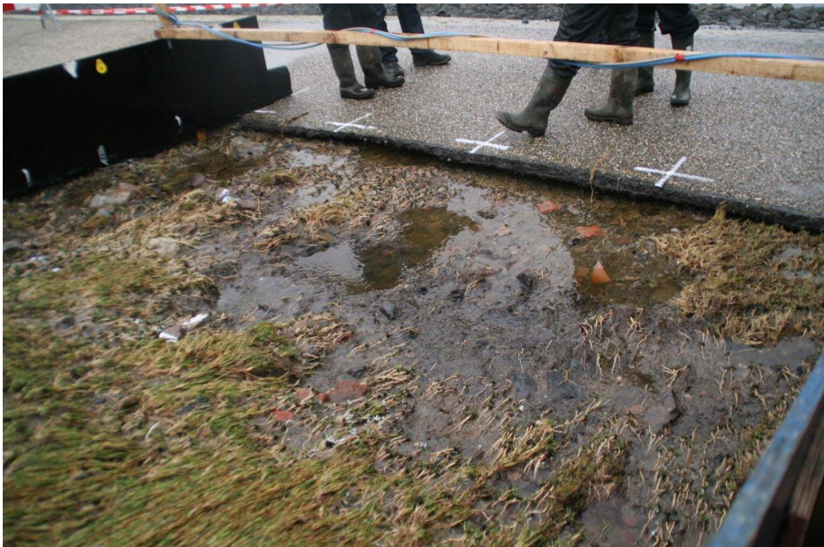
Figuur B79. Tholen. Sectie, buitentalud. Ondermijning en opdrukken asfaltberm. Einde proef. Eveneens meerder plekken schade aan open talud.
