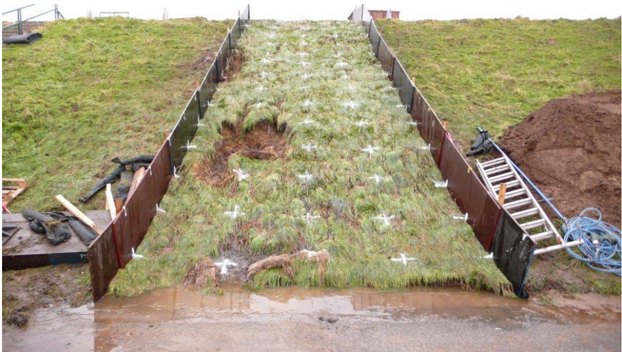
Figuur B77. Tielrode, België. Sectie 4. Bezweken talud.
