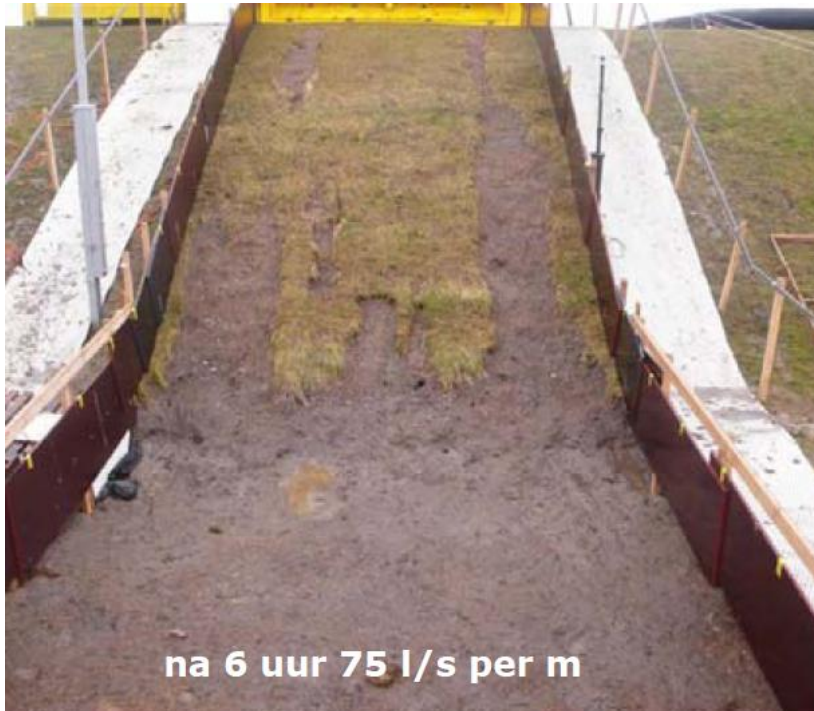
Foto B29. Afsluitdijk. Sectie 1. Erosie van de teen 0,30 m diep; talud wel kaal, maar niet bezweken.
