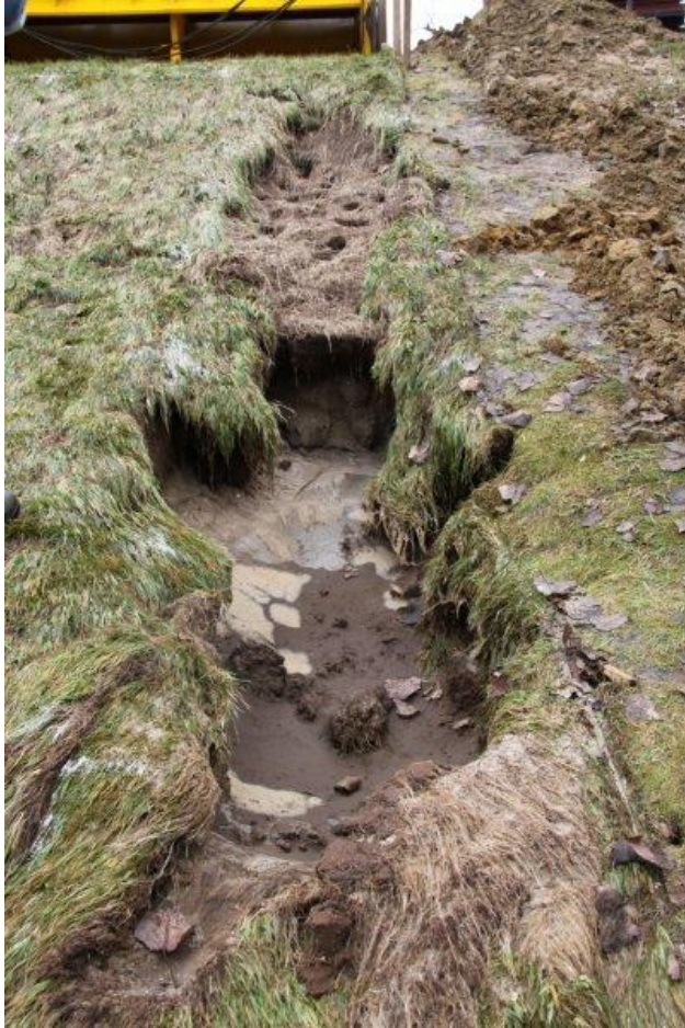
Foto B60. Vechtdijk. Rivierregime, proef 4; Gestopt, bezweken talud.
