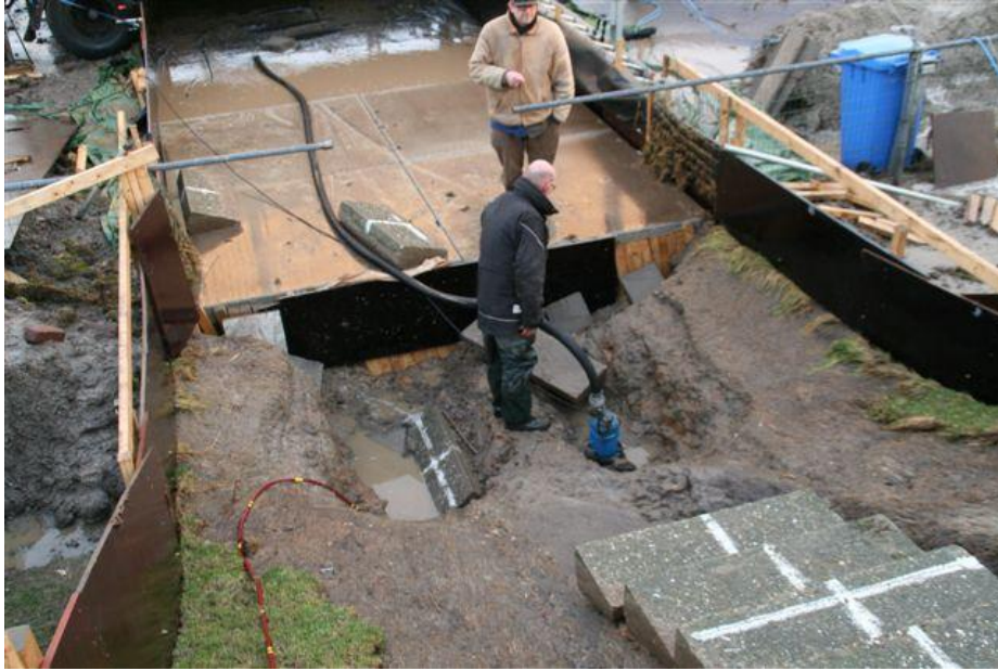
Foto B35. Afsluitdijk. Sectie 3. Erosiekuilen, 1,0 m diep door stroomconcentratie langs de trap.
