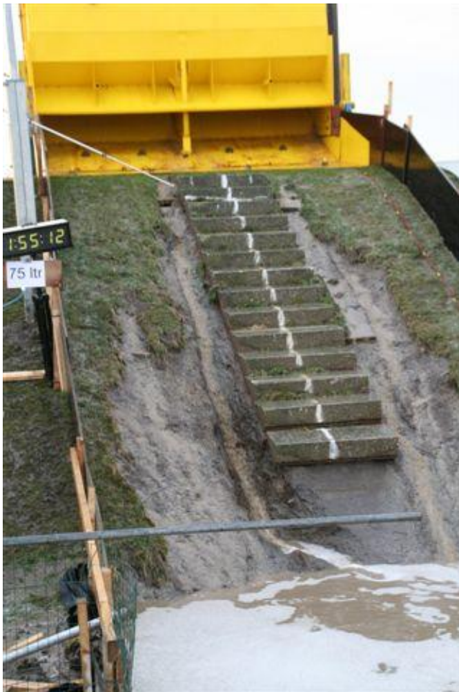
Foto B34. Afsluitdijk. Sectie 3. Bezwijken van de trap.
