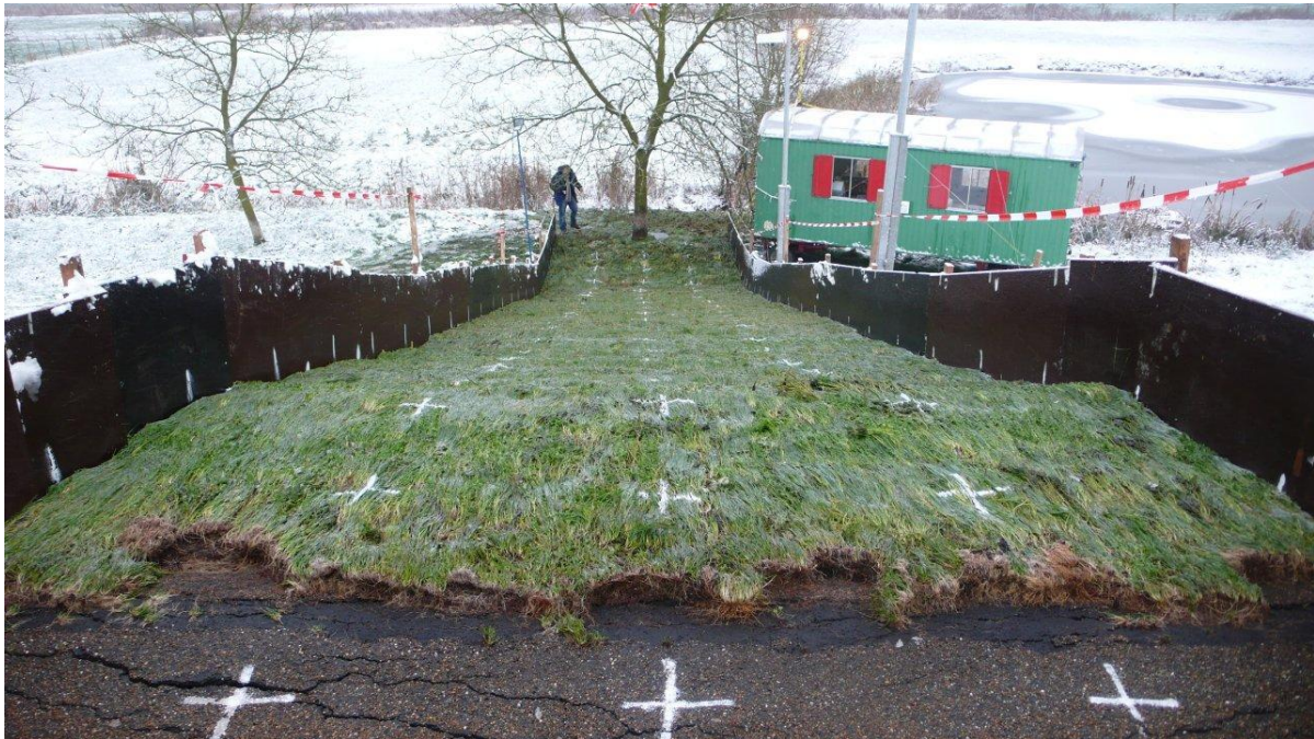
Figuur B65. Tielrode, België. Durmedijk. Na eerste serie. Begin schade overgang asfaltkruin naar gras. Geen schade aan talud of boom.
