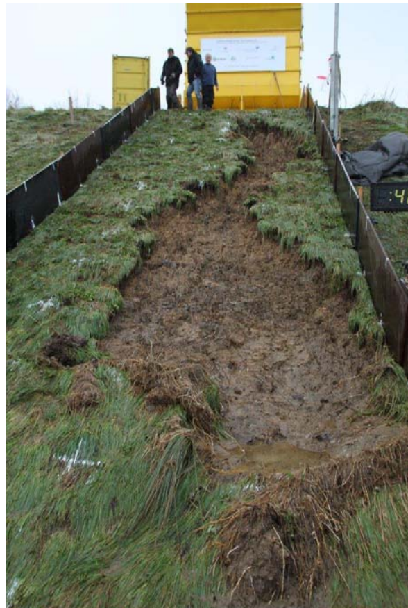
Figuur B71. Tielrode, België. Sectie 1. Bezweken talud.
