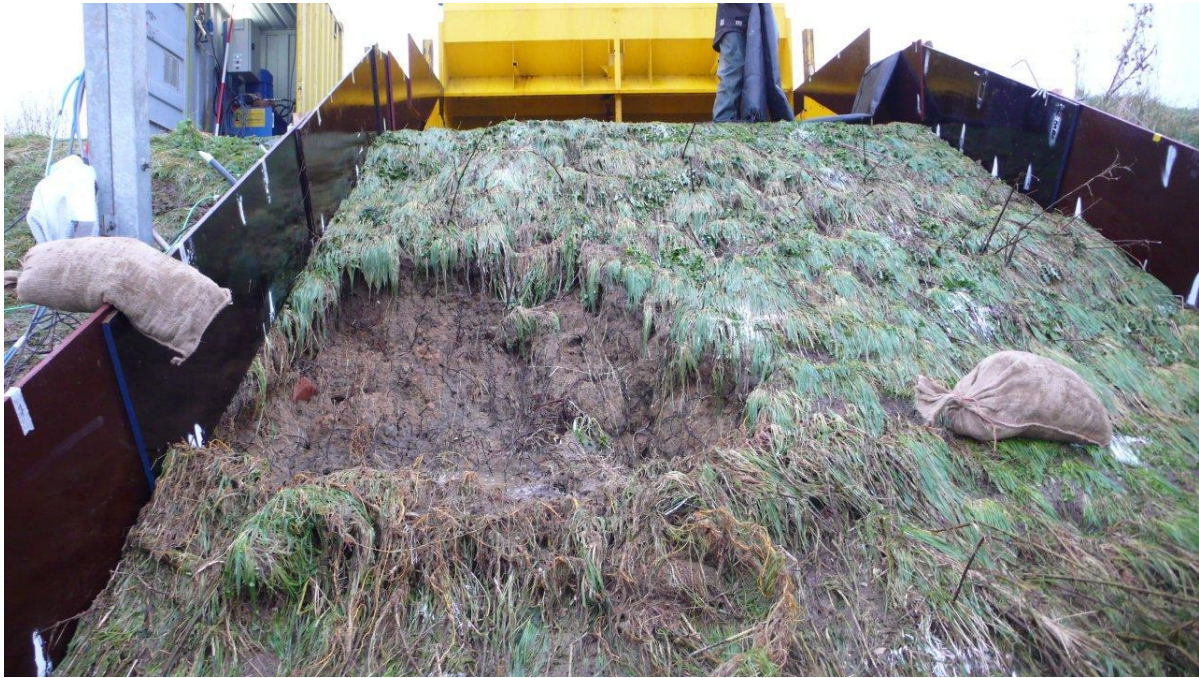
Figuur B74. Tielrode, België. Sectie 2. Bezweken talud.
