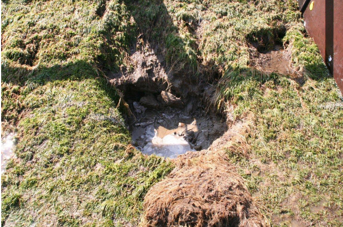
Figuur B101. Tholen, sectie 4, binnentalud. Bezweken teen.
