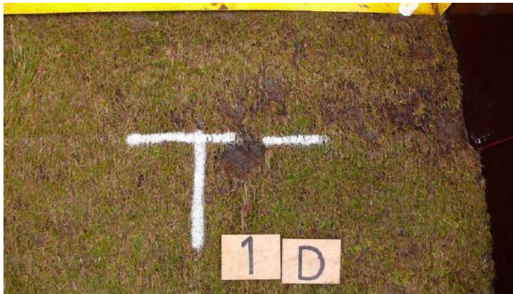
Foto B27. Afsluitdijk. Sectie 1. Begin van schade aan het talud.
