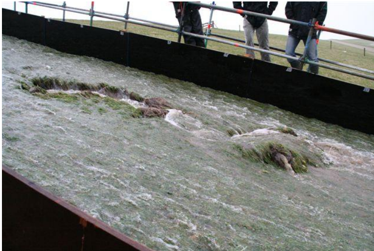
Foto B14. Boonweg, Friesland; sectie 4. Direct na het wegslaan van de eerste opbolling ontstond een tweede opbolling. Deze "lekte" water.
