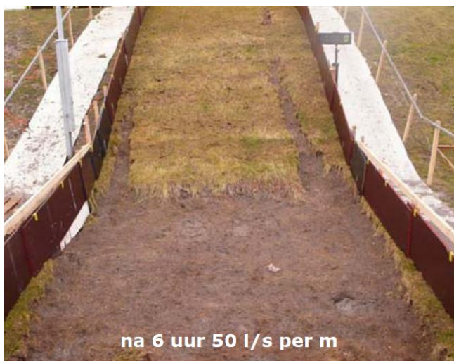
Foto B28. Afsluitdijk. Sectie 1. Meerdere kale plekken op talud en gras verdwenen bij teen.
