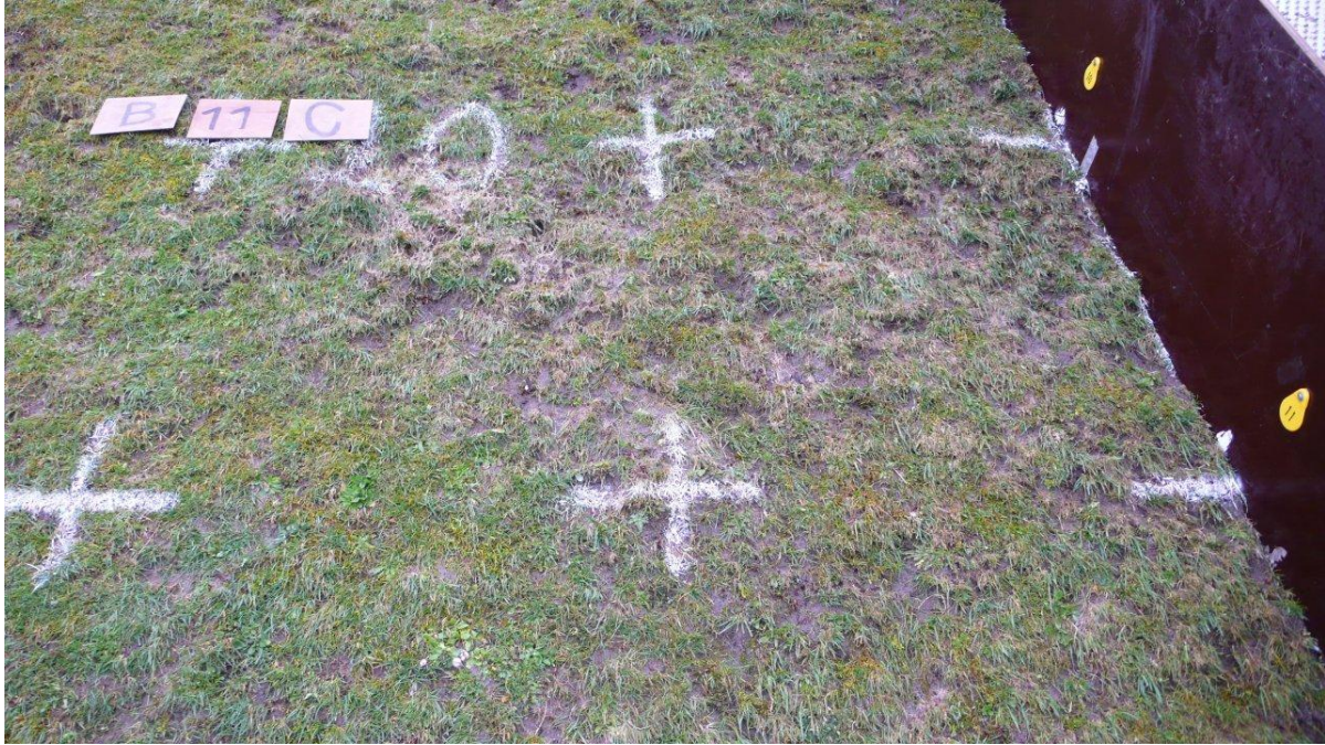
Figuur B96. Tholen, sectie 4, binnentalud. Meerder plekken schade talud.
