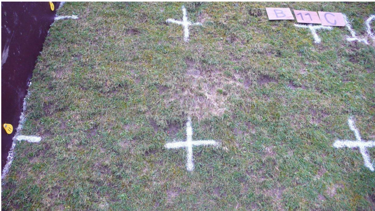
Figuur B95. Tholen, sectie 4, binnentalud. Begin schade talud.
