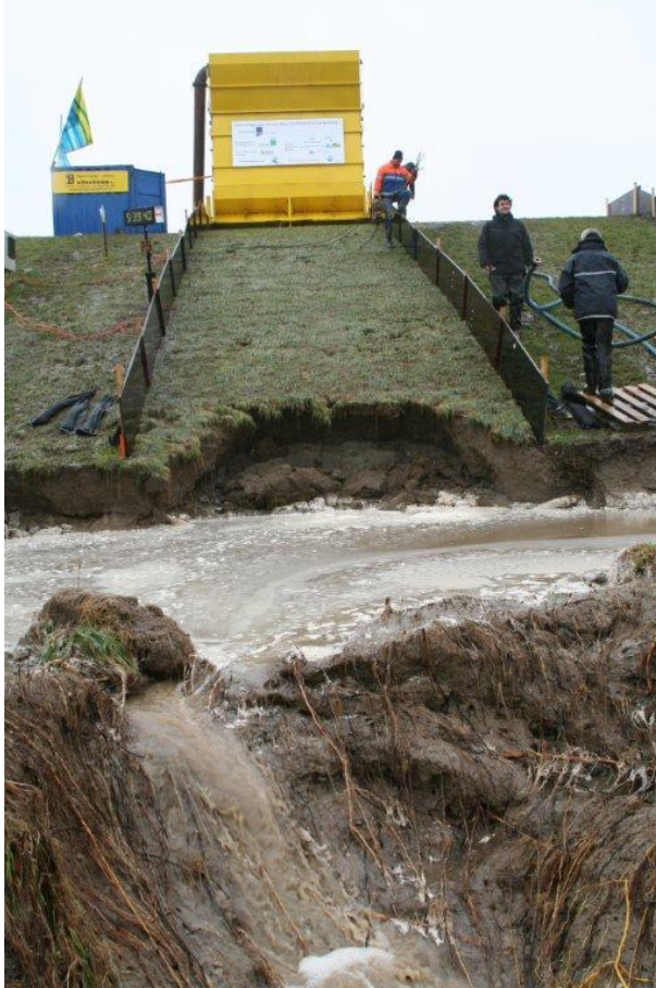
Foto B22. Kattendijke. Sectie 1. Aan het einde van de proef. Geen schade aan het talud, bezwijken van teen met onderhoudsweg, leidende tot headcut erosie op het talud.
