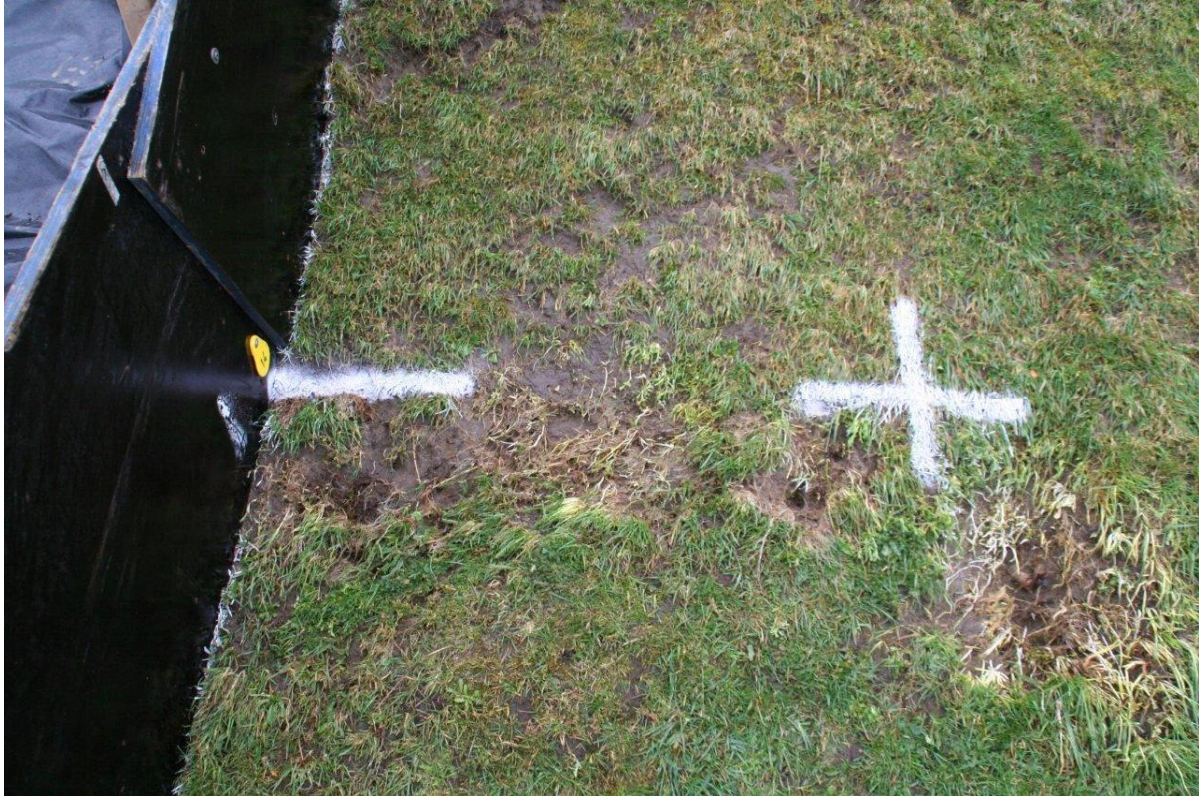
Figuur B100. Tholen, sectie 4, binnentalud. Meerdere plekken schade aan de teen.
