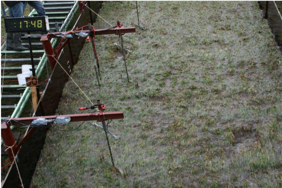
Foto B18. St Philipsland. Begin van schade aan het talud (twee plekken)
