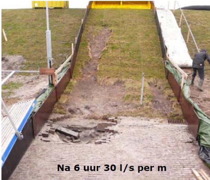
Foto B31. Afsluitdijk. Sectie 2. Bezwijken van de klinkerbestrating op zand.
