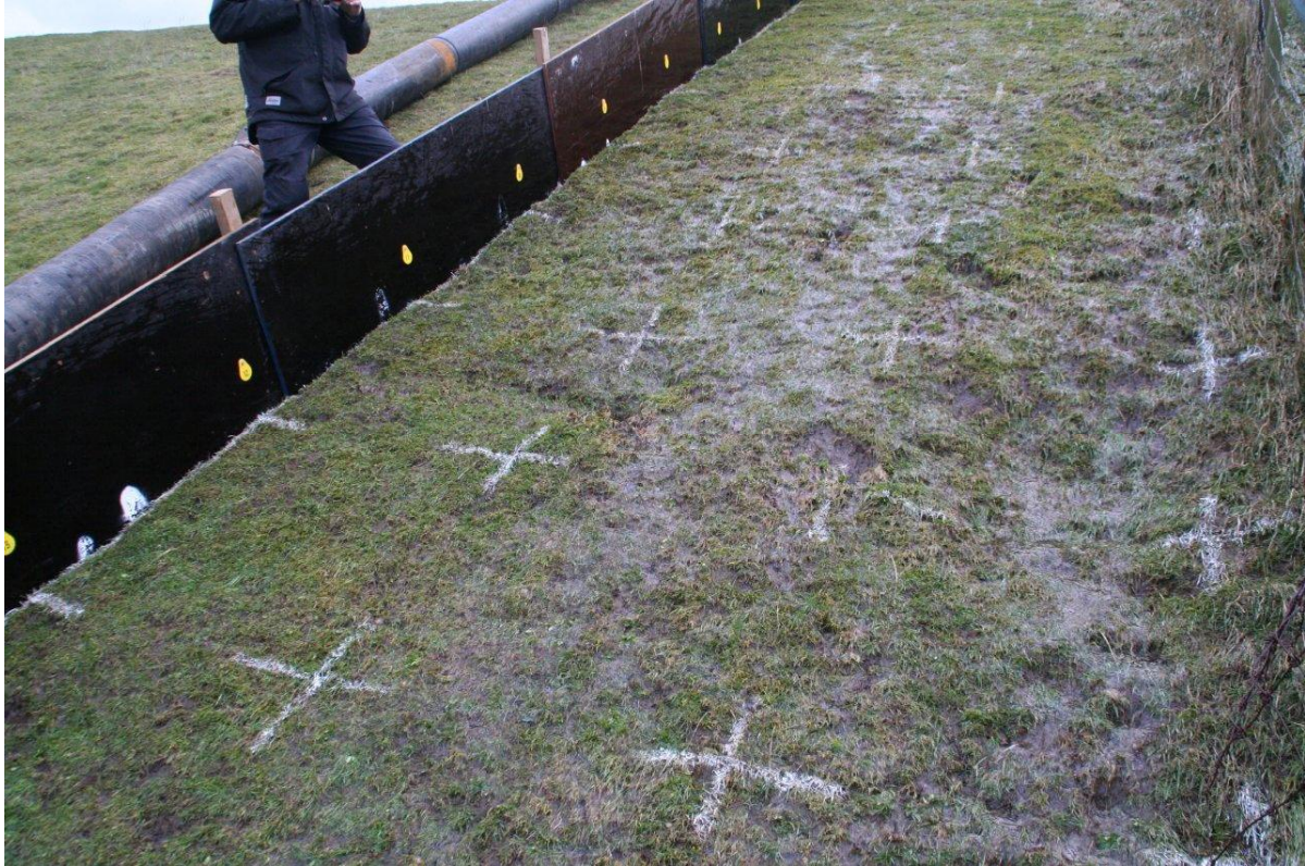
Figuur B88. Tholen. Sectie 3, afrastering. Verzakking van het talud (rechts).
