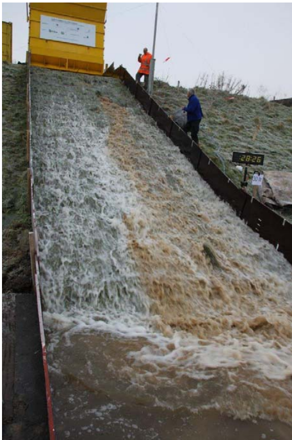
Figuur B70. Tielrode, België. Sectie 1. Meerdere plekken schade en twee zandvoerende openingen.
