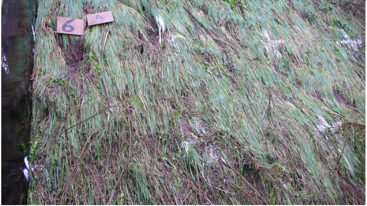
Figuur B72. Tielrode, België. Sectie 2. Begin van schade.
