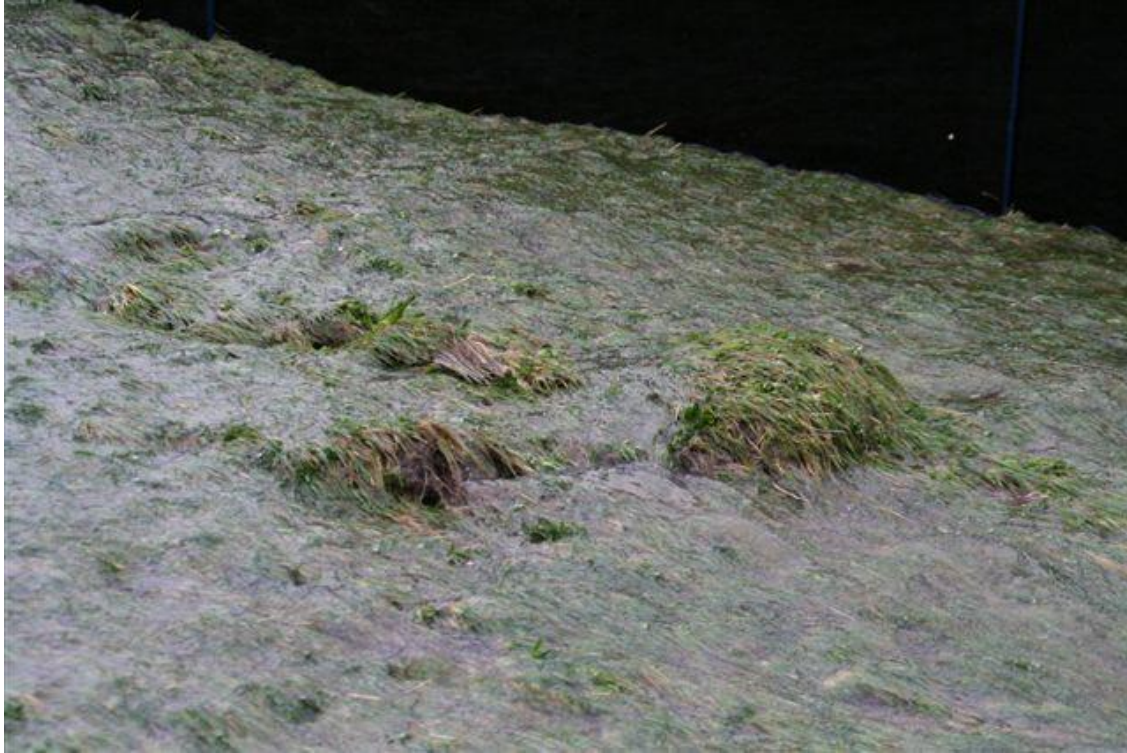
Foto B12. Boonweg. Sectie 4. Begin van schade (opbolmechanisme) aan het talud.
