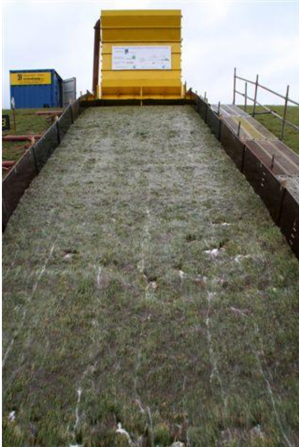
Foto B20. Kattendijke, Zeeland, sectie 1. Talud vol met mollengaten.
