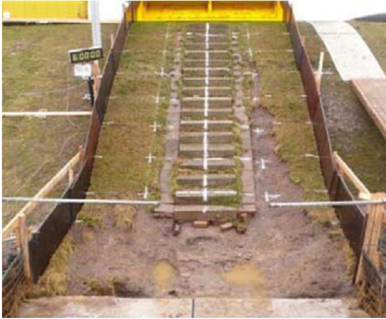
Foto B33. Afsluitdijk. Sectie 3. Meerdere/grotere kale plekken op het talud.
