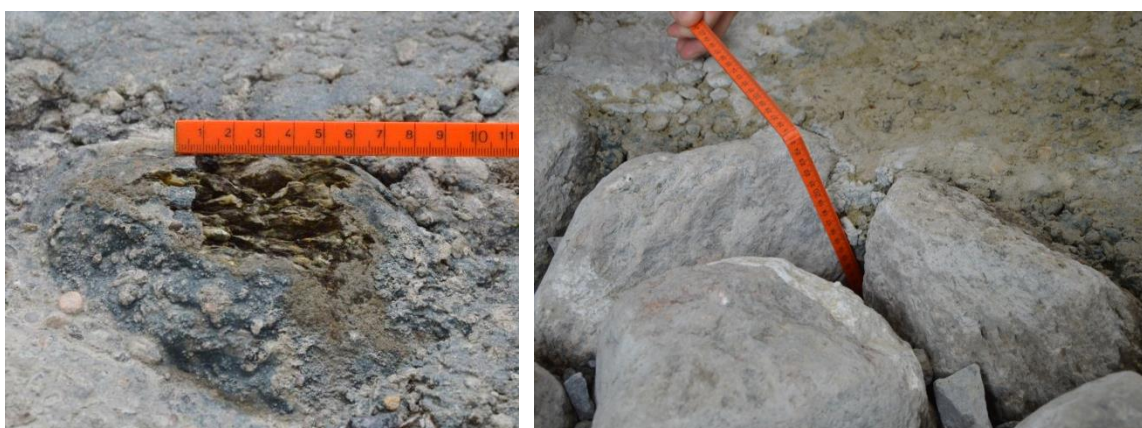
Figuur 6.3 Links: tijdens proef N06 is het gat in de vlint bij [ x' = 8,25 m; Y = 1,3 ] wat groter geworden. Rechts: rond lijn 1 was in enkele gaten en spleten het inwasmateriaal tot 15 à 25 cm diep uitgespoeld.
