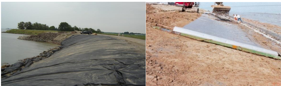
Figuur 5: Aanbrengen geotextiel links; van boven naar beneden uitrollen, rechts; horizontaal uitrollen [1]
