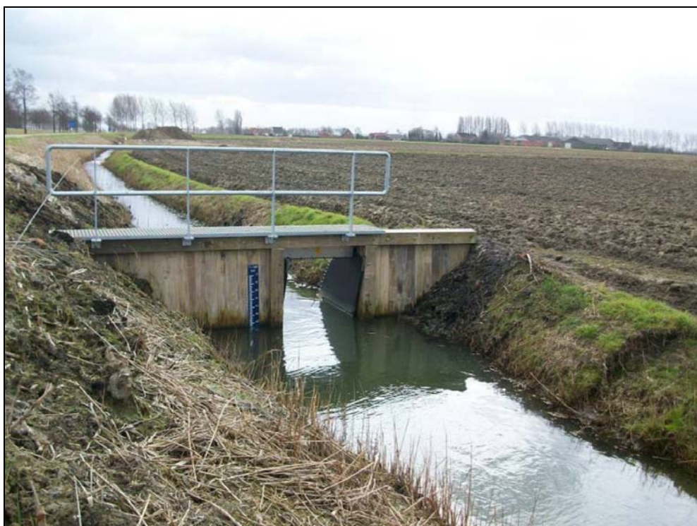
Figuur 5.8 Peilregulerende stuw deel Noordhofpolder
