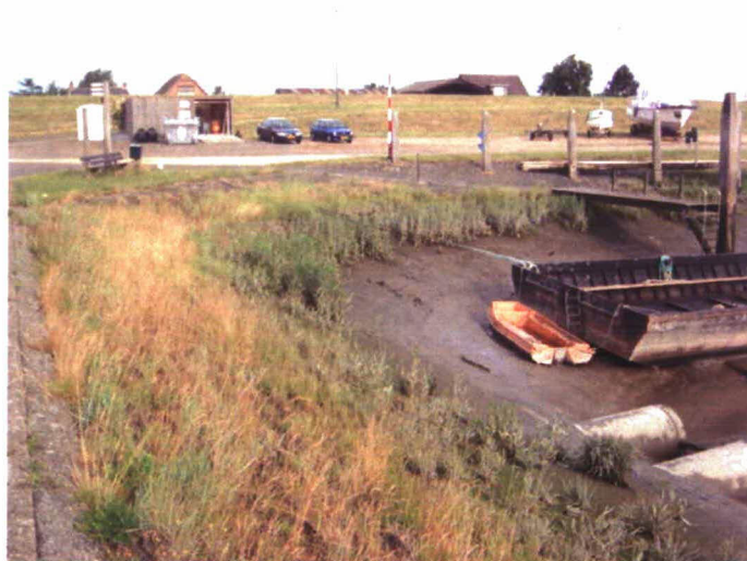
Figuur 22: Huidige situatie tussen boothelling en dam tussen spuibecken en haven van Paal
