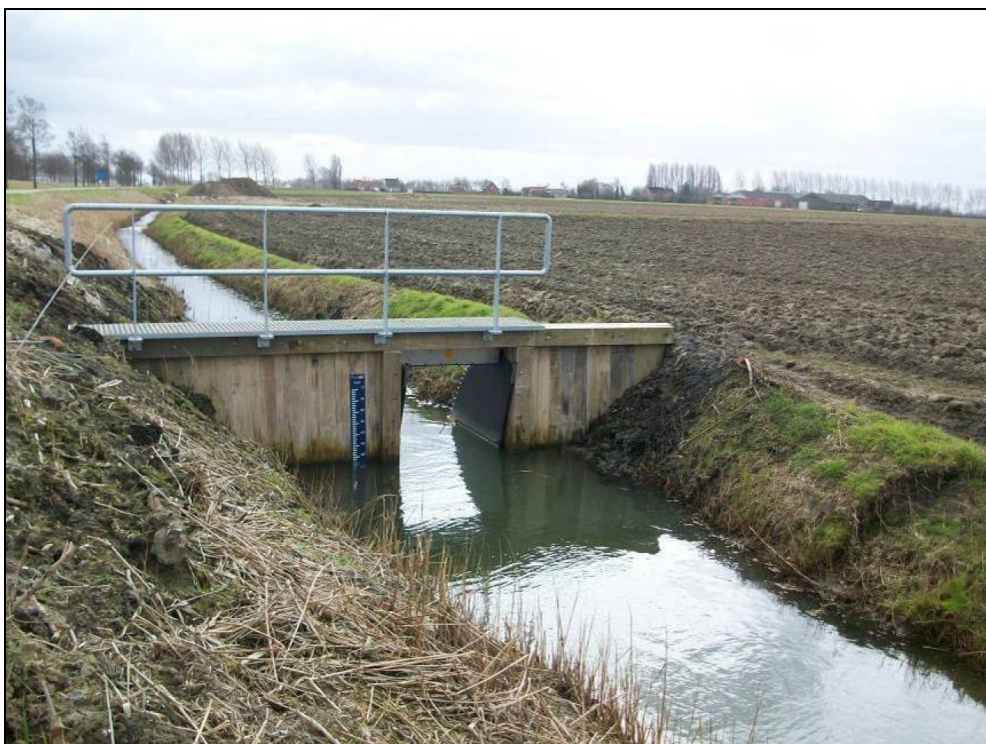
Figuur 5.6 Peilregulerende stuw deel Noordhofpolder
