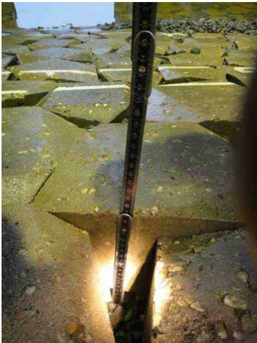
b) Schade na proef 3
