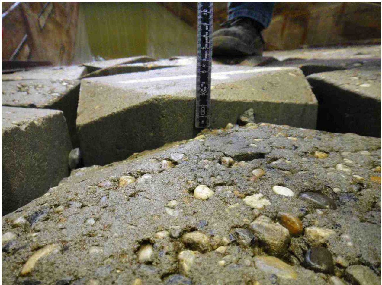
b) Schade na proef 8 (3)
