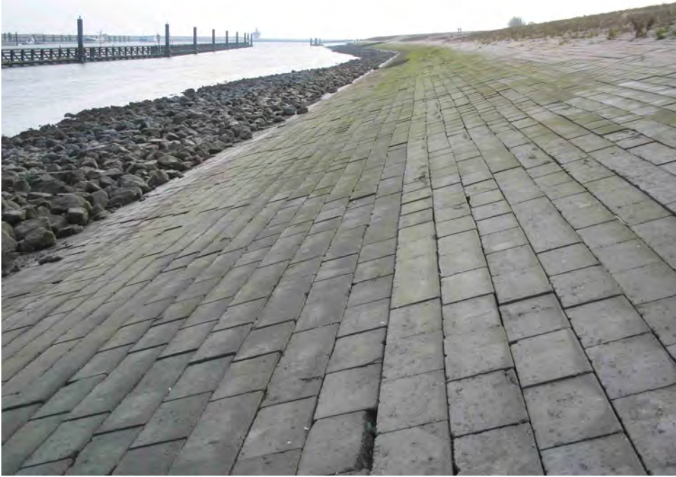
Gekantelde betonblokken. Nabij Hansweert, 7 november 2008 (Martien Meijer; Bureau Waardenburg).
