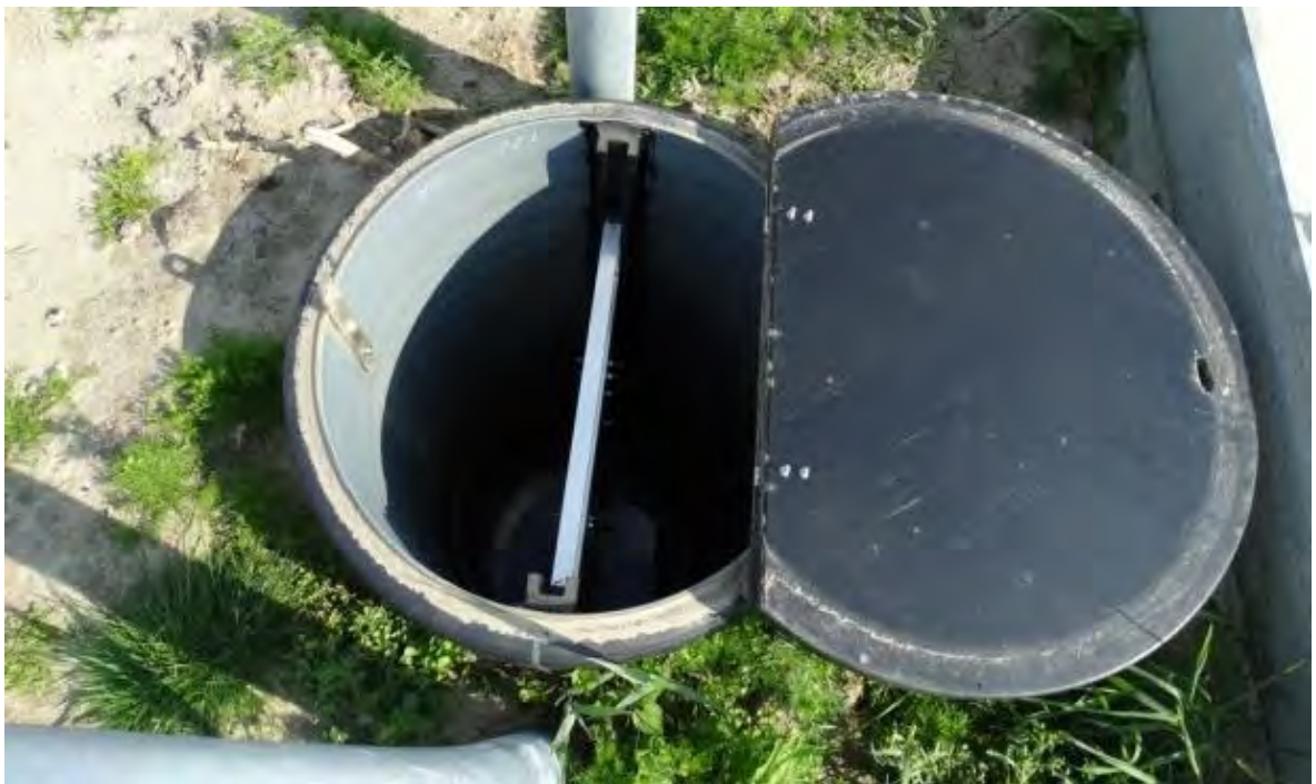
Figure 36. Foto van een regelput met stuwplankje.
