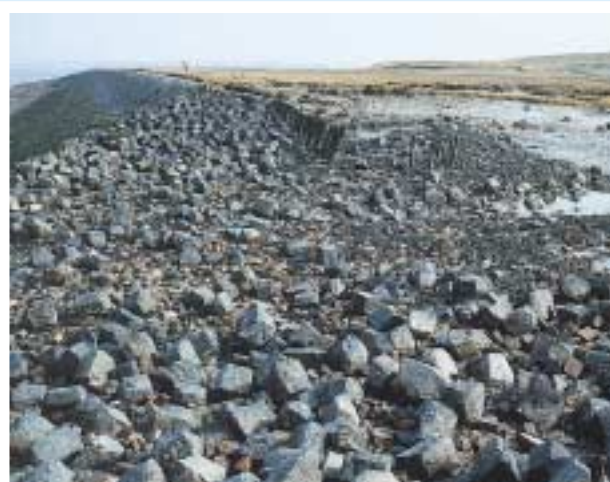
Foto 19 De stenen glooiing bij het Zijpe kende oorspronkelijk geen openingen. Door ondermijning is een bres geslagen in de steenglooiing, waardoor de wateruitwisseling tussen het schor en de geul is verbeterd.
