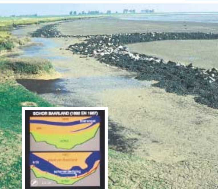
Foto 23 De verdediging bij het schor van Baarland bestond uit een aantal stenen kribben, ongeveer loodrecht gelegen ten opzichte van de schorrand, en een stenen verdediging tegen de schorrand. Deze verdedigingen zijn in 1942 door het Waterschap aangelegd om de waterkering te beschermen tegen de opdringing van de geul het Boerengat (zie inzet). De kribben hebben hun werk gedaan, maar de verdediging tegen de schorrand niet. Deze is ondermijnd geraakt en ligt nu als een losse verzameling stenen op en in het slik. Het schorklif is nog een tiental meters verder afgeslagen.
