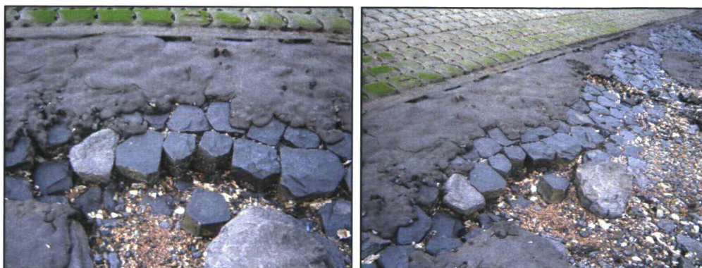
Foto's 1 en 2: herzette basalt op het gedeelte tussen de dijkpalen 308 +50m en 309 +90m
