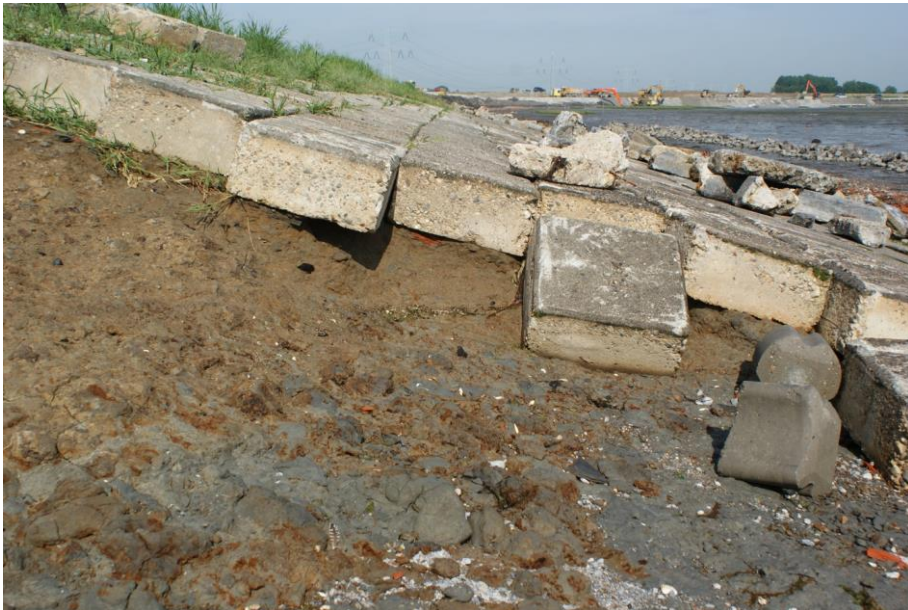
Afb.6. oude dijkbekleding met betonblokken uit 1943.
