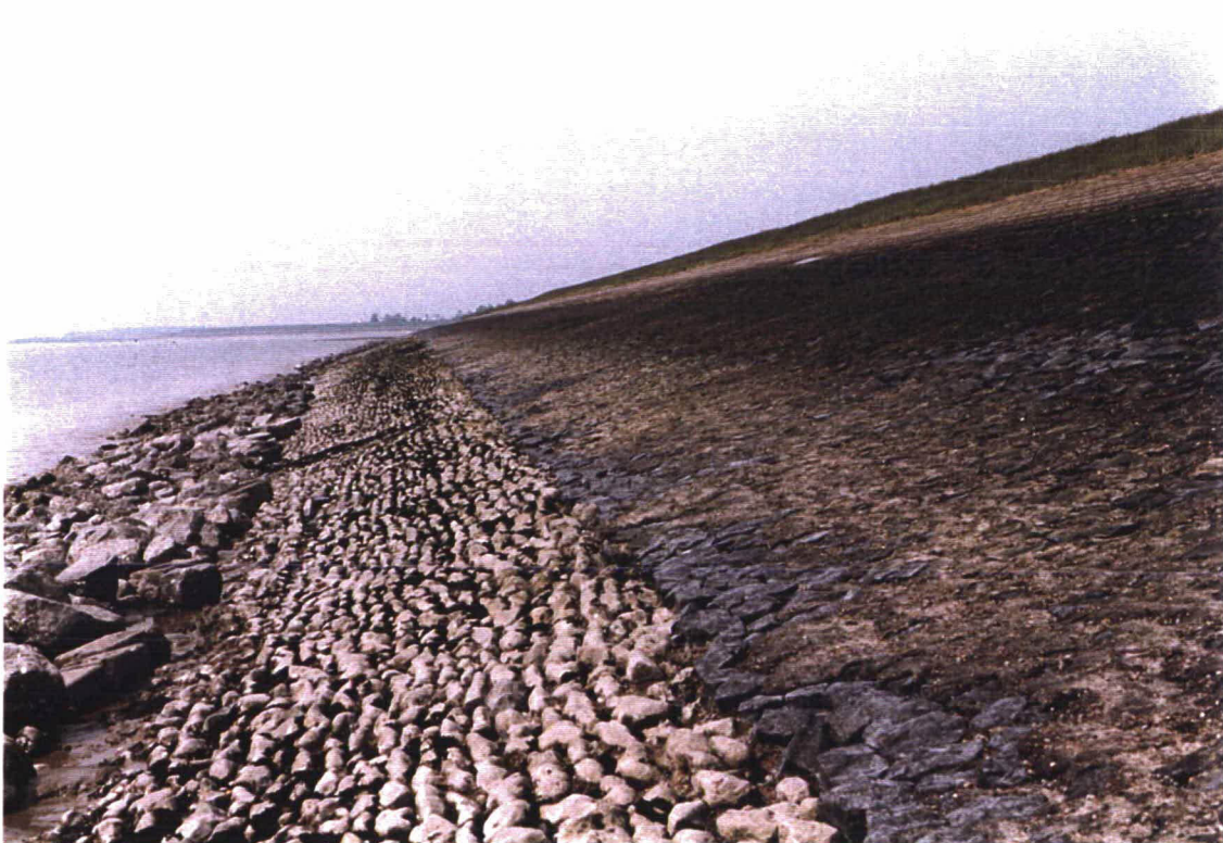
Foto 24 Overzicht van het vak waar de penetratie asfalt blijkt te zijn in plaats van beton (km 17,6, foto genomen in westelijke richting).
