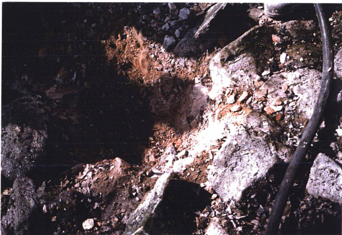
Foto 2 Gat in de overlaging bij km 15.
