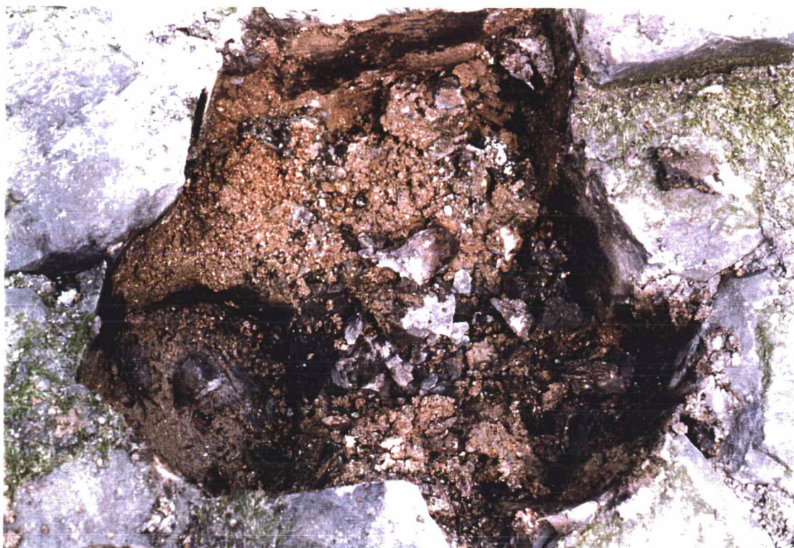
Foto 25 Gat in de bekleding: de penetratie blijkt tot onderin de spleten te zijn doorgedrongen (km 17,6).
