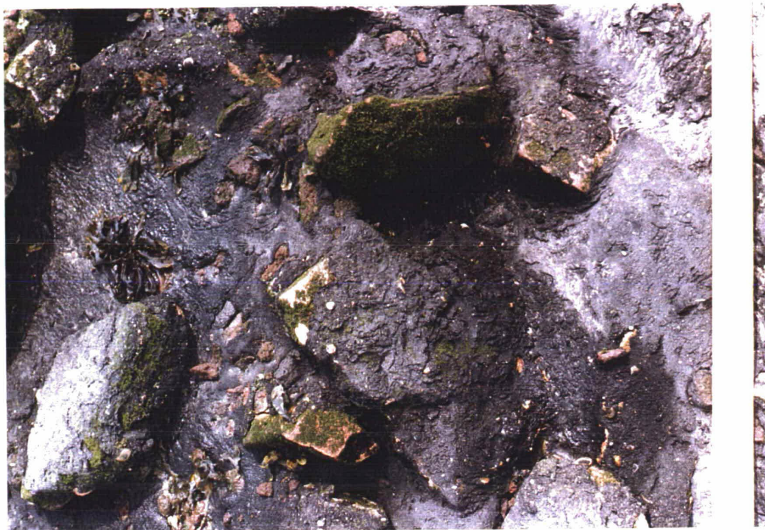
Foto 3 Detail van de overlaging (km 15).
