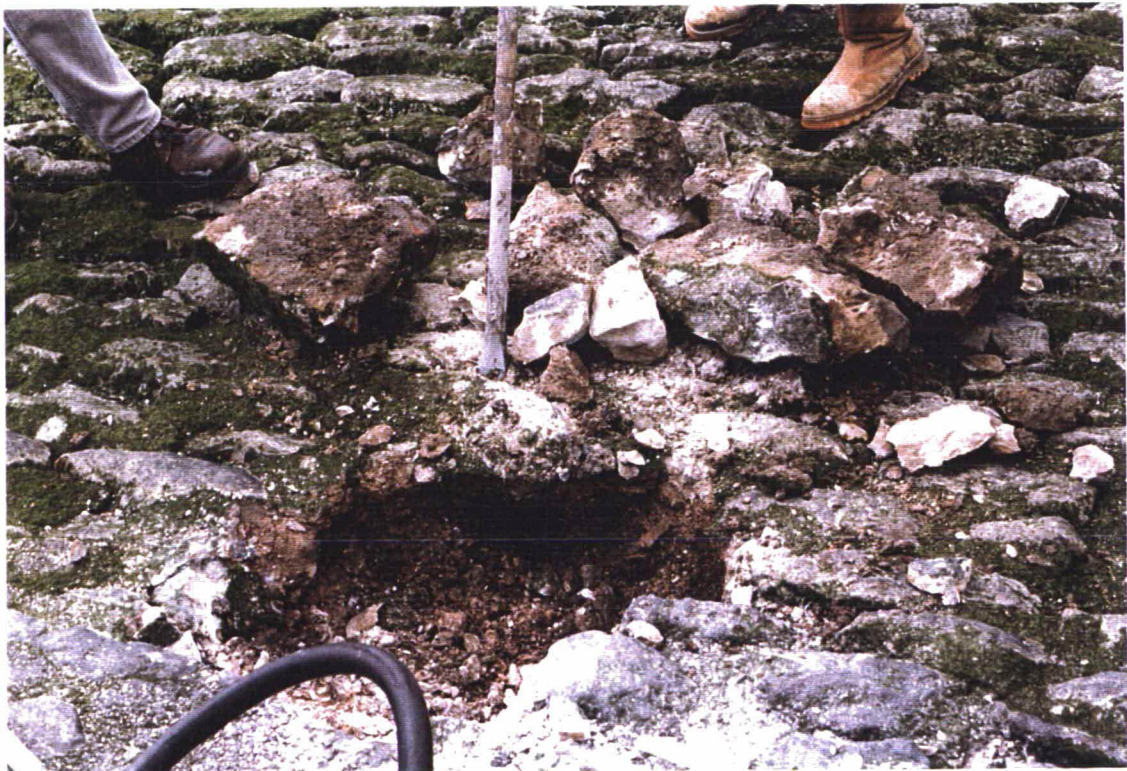
Foto 8 Gat in de gepenetreerde Vilvoordse steen (km 15,7).
