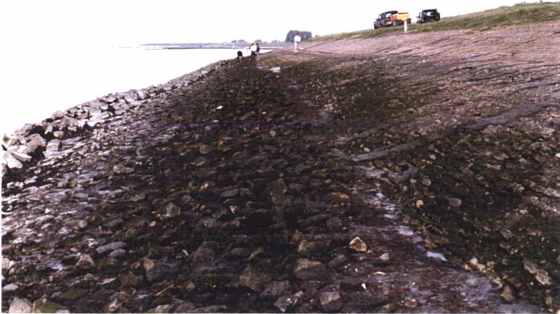
Foto 1 Overlagingsconstructie van met asfalt gepenetreerde stortsteen. Overzicht van de locatie. Genomen bij km 14,9 in westelijke richting.
