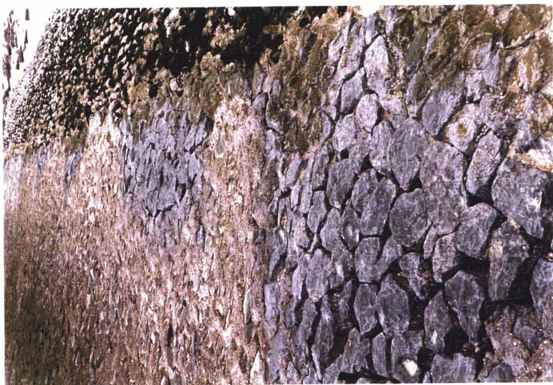
Foto 26 In de bekleding zitten plaatsen waar de penetratie is verdwenen (km 17,7).
