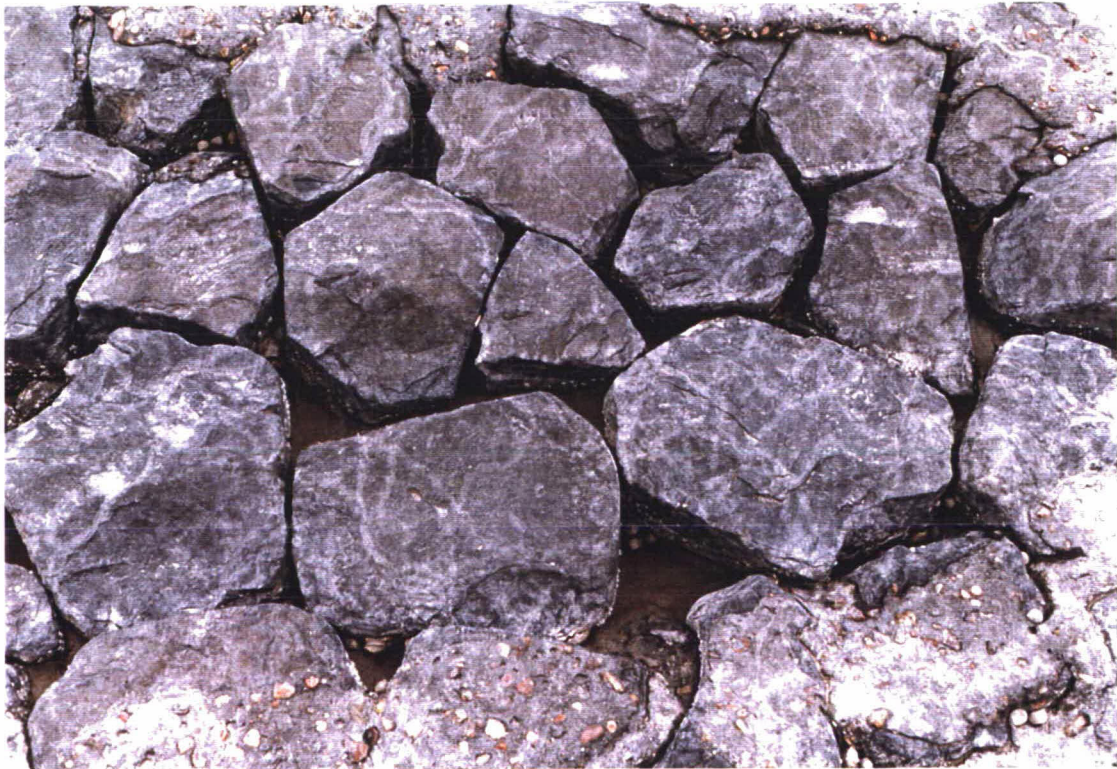
Foto 14 Deel van de penetratie is verdwenen (km 16,4).
