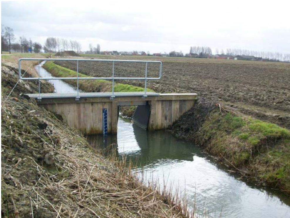
Figuur 6.6. Peilregulerende stuw deel Noordhofpolder
