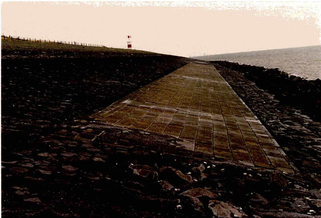
Foto 12 Vanaf dp 33 + 80 m is een klein stuk met diaboolblokken aanwezig. Bij de overgang is weer een shadeplek zichtbaar.
