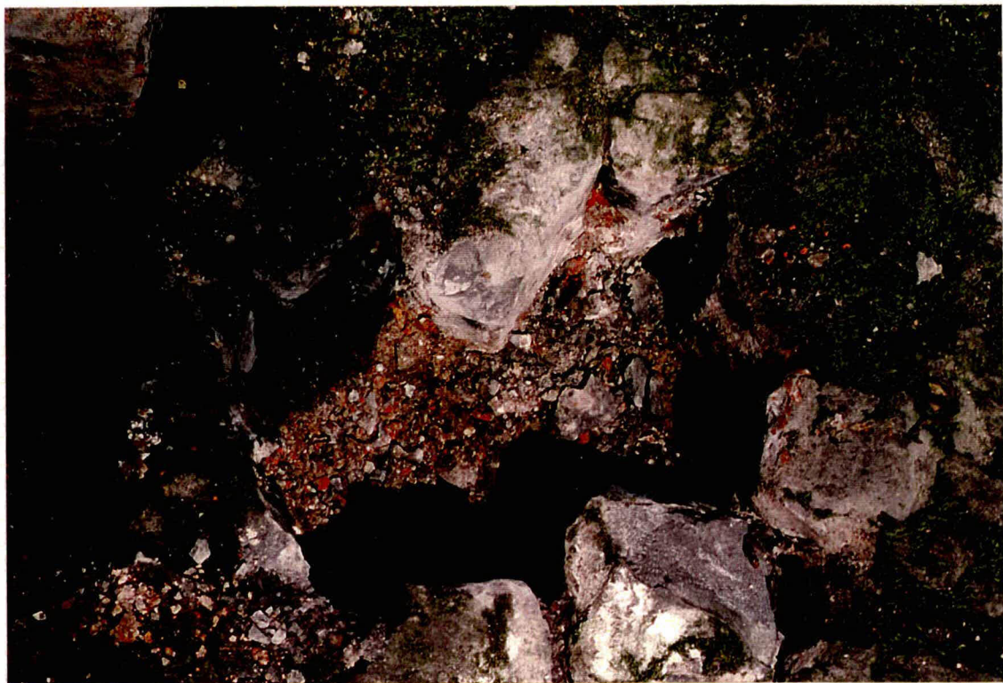
Foto 4 Gat hoog op het talud bij dp 38 + 50 m. Ook hier is het filter dicht.
