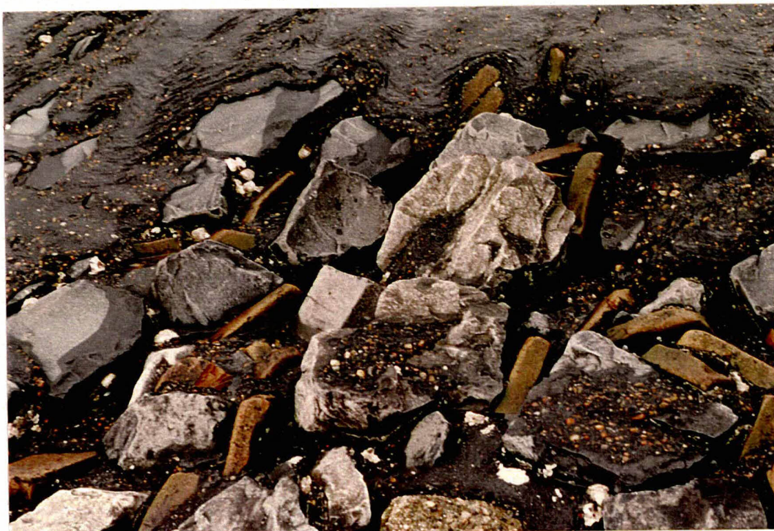
Foto 10 Schadeplek bij dp 34 + 50 m. De schade is gerepareerd met stortsteen, baksteen en asfaltpenetratie.
