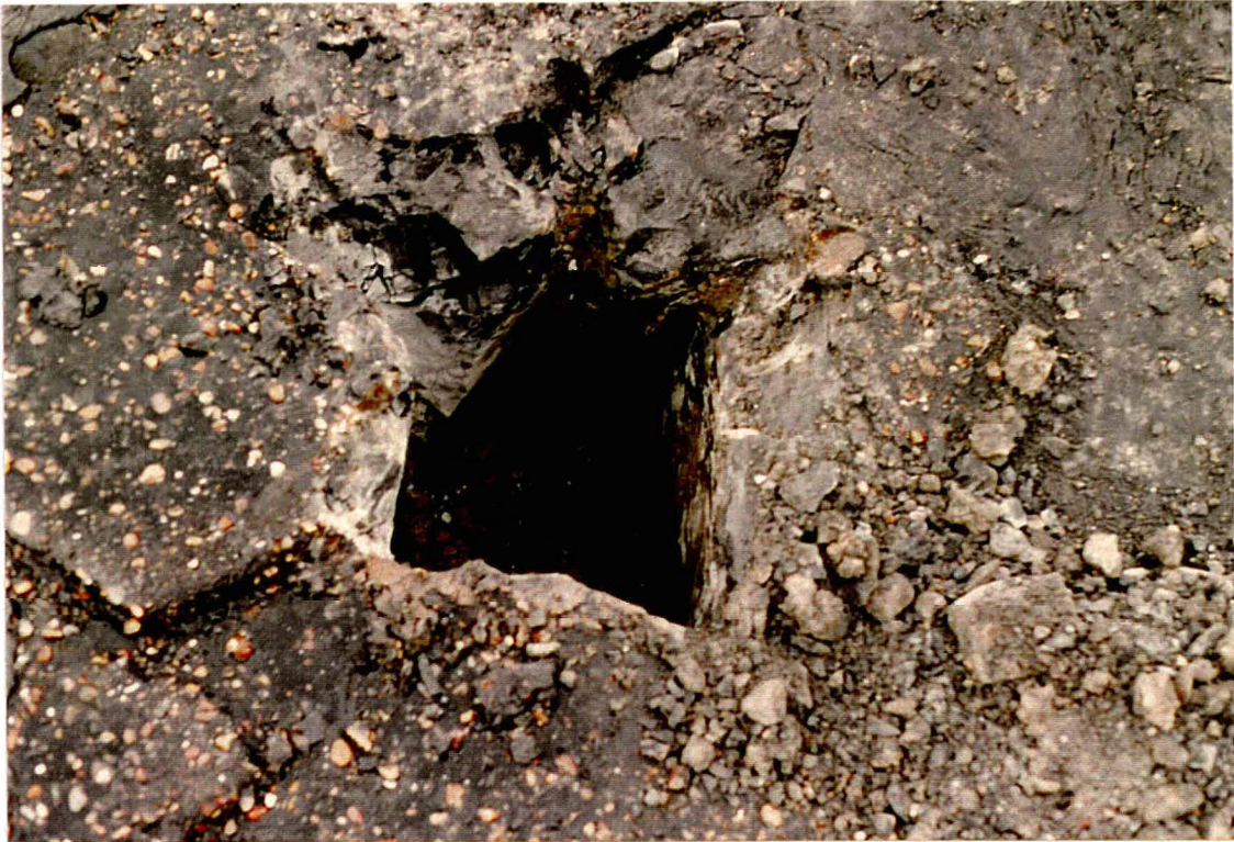
Foto 13 Gat hoog in het talud bij dp 34. Het filter is dichtgeslibd.
