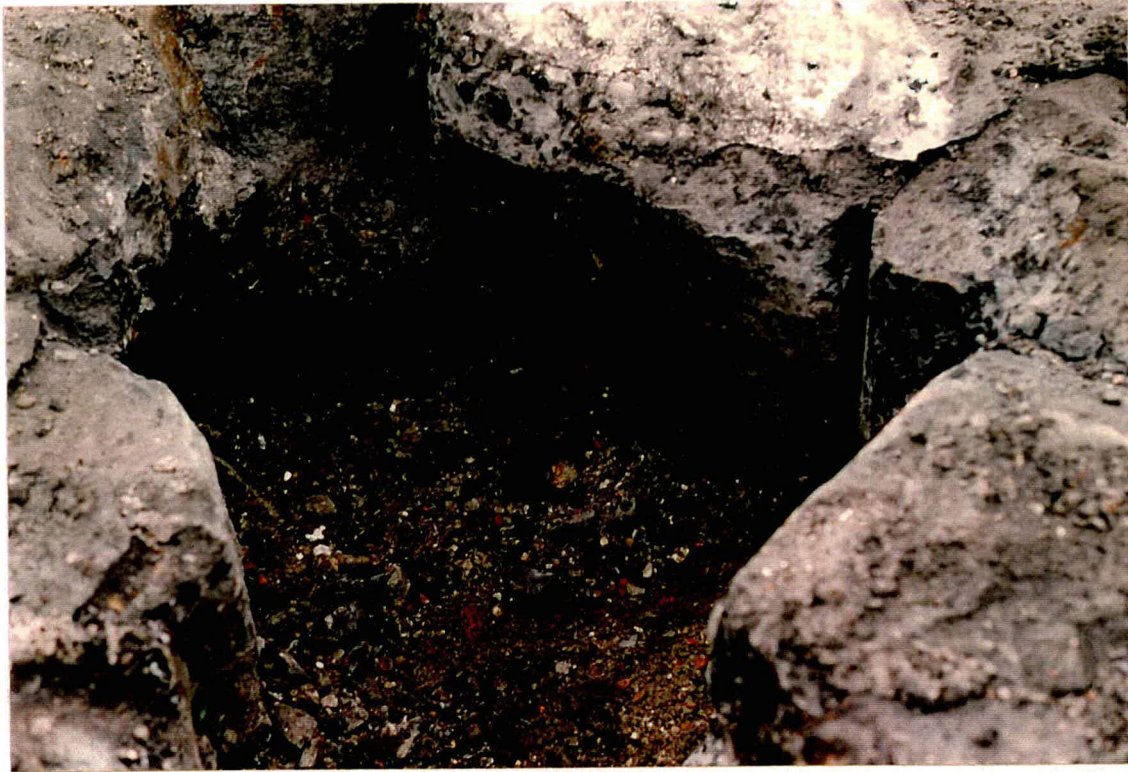
Foto 3 Gat laag op het talud bij dp 38 + 50 m. Het filter is dichtgeslibd.
