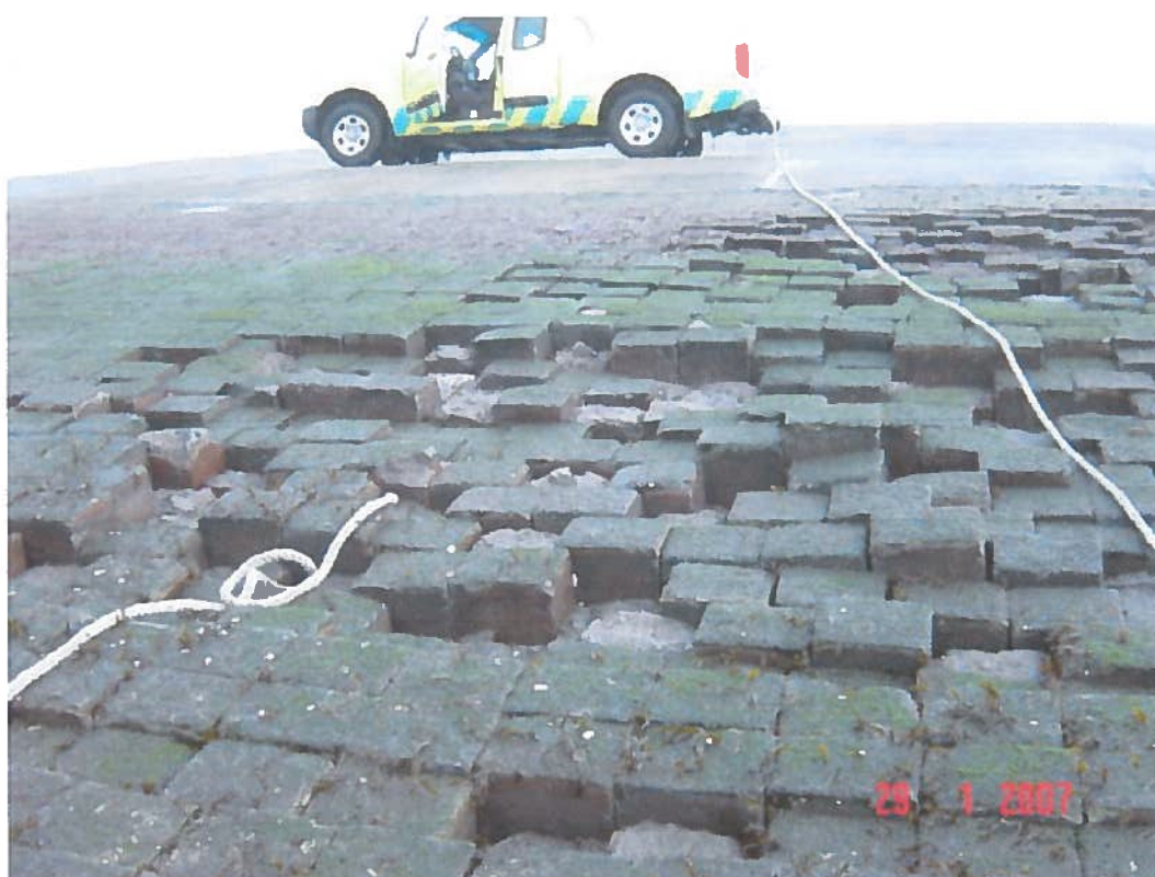
Figuur 3: Stormschade aangericht door storm 18 januari 2007
