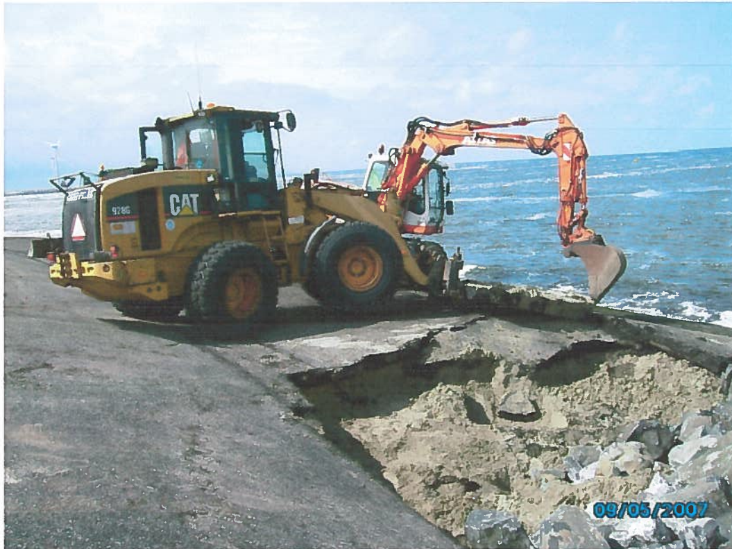
Figuur 4: Schades ontstaan in mei 2007
