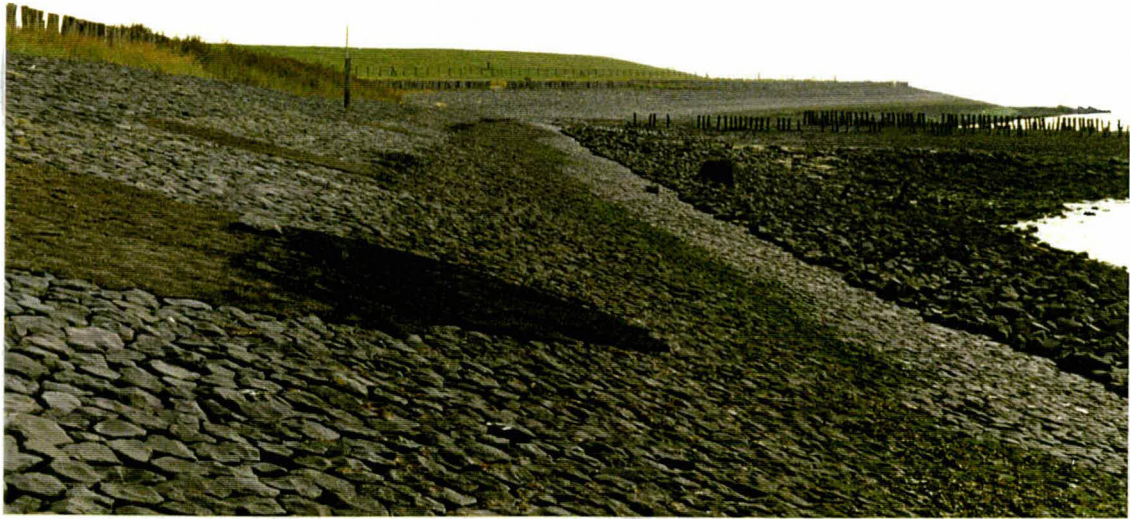
Foto 11 Bij km 75,35 zijn shadeplekken aangetroffen.
