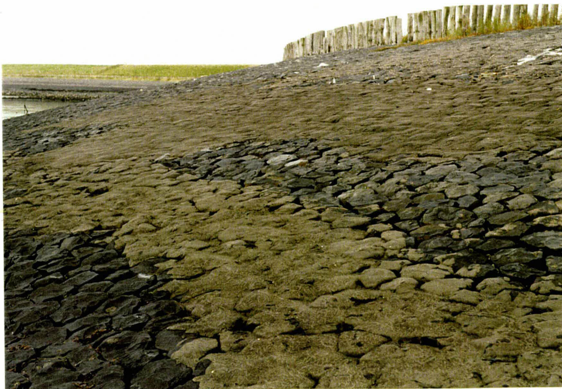
Foto 9 In de bocht bij km 74,5 zit een grote schadeplek.
