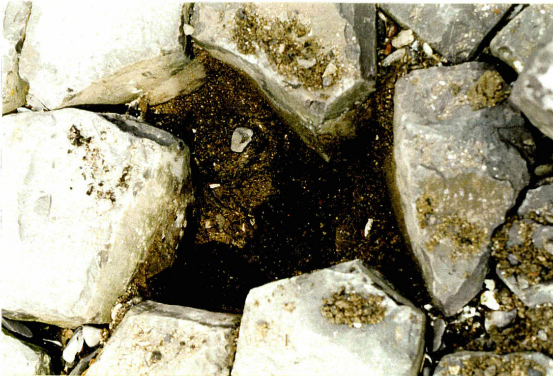
Foto 2 Gat hoog in het talud bij km 73,25. Het filter en de toplaag zijn ingezand.
