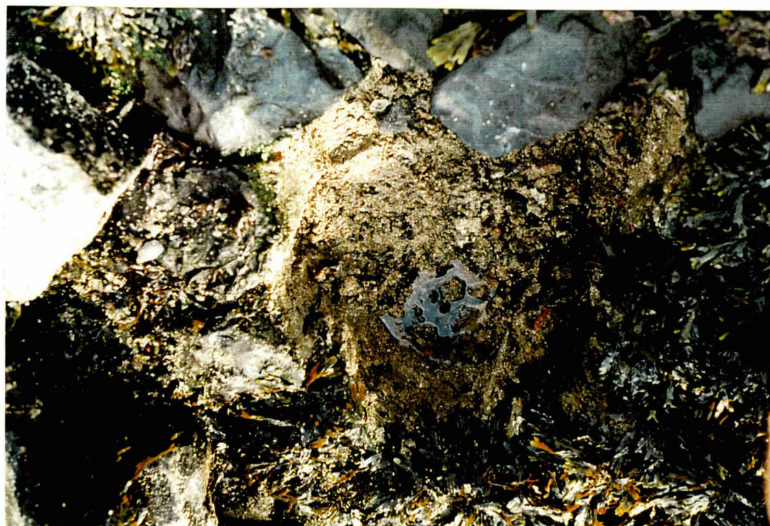
Foto 18 Gat bij km 75,9. Het filter en de toplaag zijn volledig dichtgeslibd, in het gat staat nog water in het filter.
