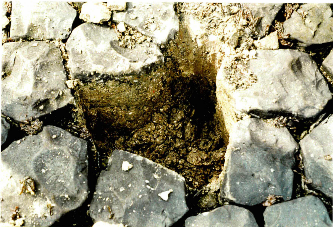
Foto 14 Bij km 75,4 is weer een gat gemaakt. Zowel toplaag als filter zijn dichtgeslibd.
