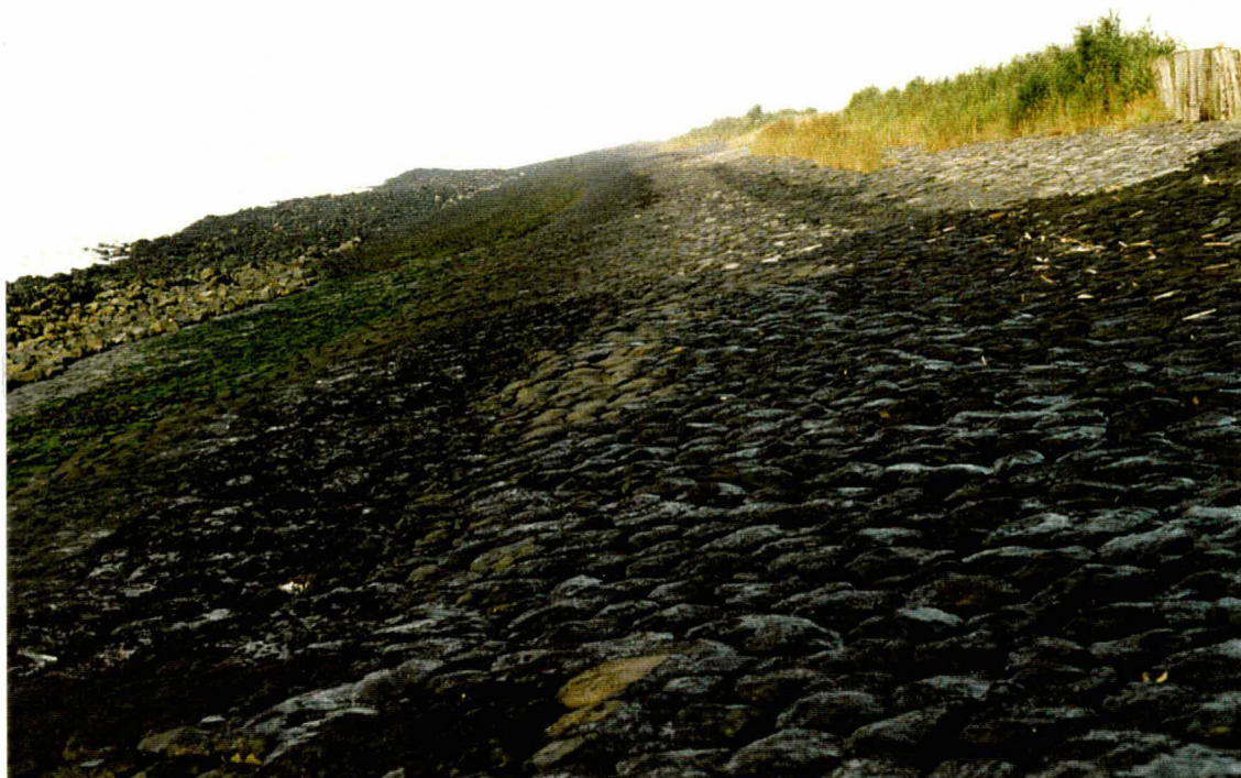
Foto 15 Overzicht van het einde van het gepenetreerde vak in westelijke richting. De penetratie is hier over vrijwel de gehele hoogte aanwezig.
