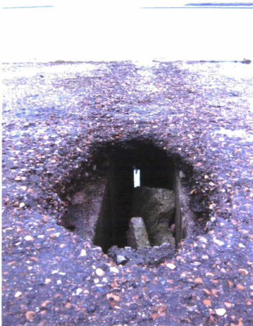
Foto 6: Gat tussen 2 caissons op asfaltplateau
