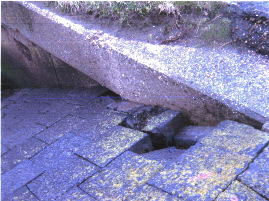
Foto 5: Gloomingschade bij aansluiting ter hoogte dijkspaal 75
