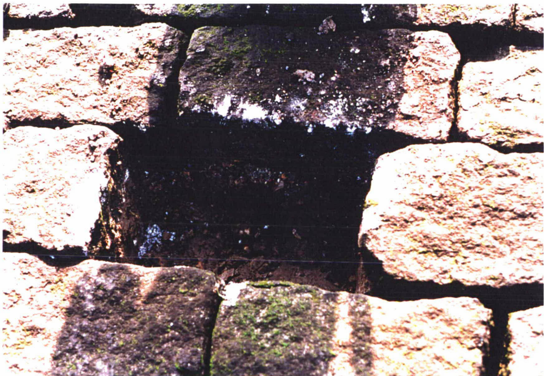
Foto 4 Gat in bekleding 33801. Het steenslagfilter is dichtgeslibd.
