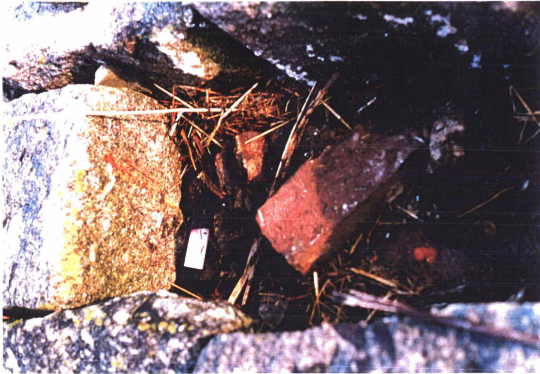
Foto 1 Gat in de bekleding in vak 1. Het filter bestaat uit grof puin en is niet ingezand.
