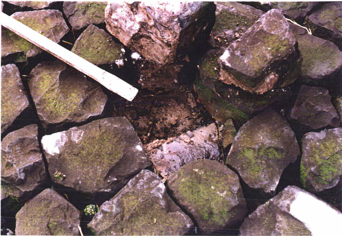
Foto 7 Gat in de basaltbekleding. Het filter is dichtgeslibd, de toplaag is onderin dichtgeslibd, maar verder open.
