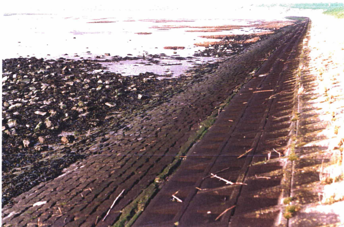
Foto 6 Einde van vak 2 (bekleding 33806). Hierachter begint de basaltbekleding (33903).
