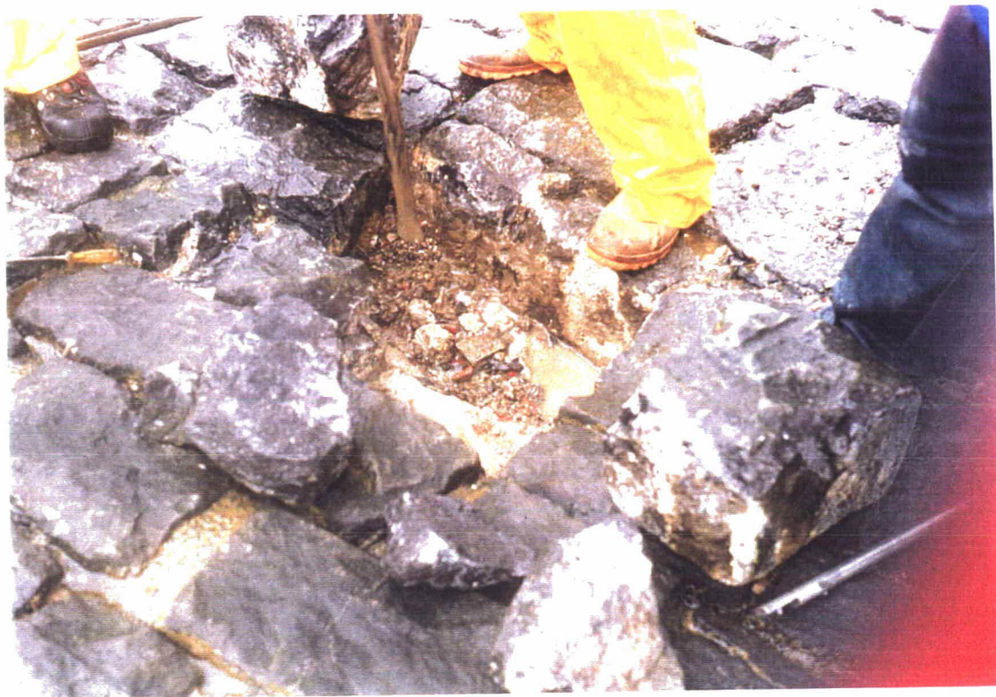
Foto 17 Gat in de granietbekleding. Het filter is ondoorlatend geworden, er stond nog water in het gat. De ingieting is tot op het filter doorgedrongen.
