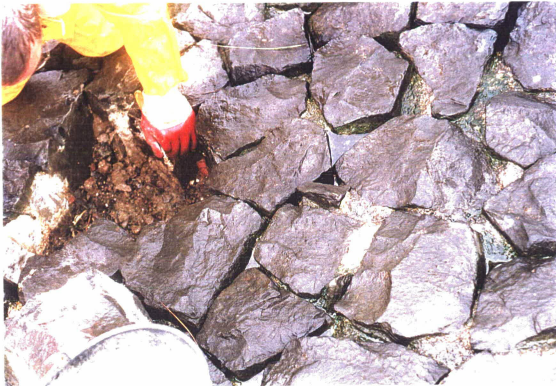
Foto 15 Gat in bekleding 29702. Het filter is dichtgeslibd, de penetratie lijkt deels uitgespoeld, maar rondom het gat is de penetratie redelijk.
