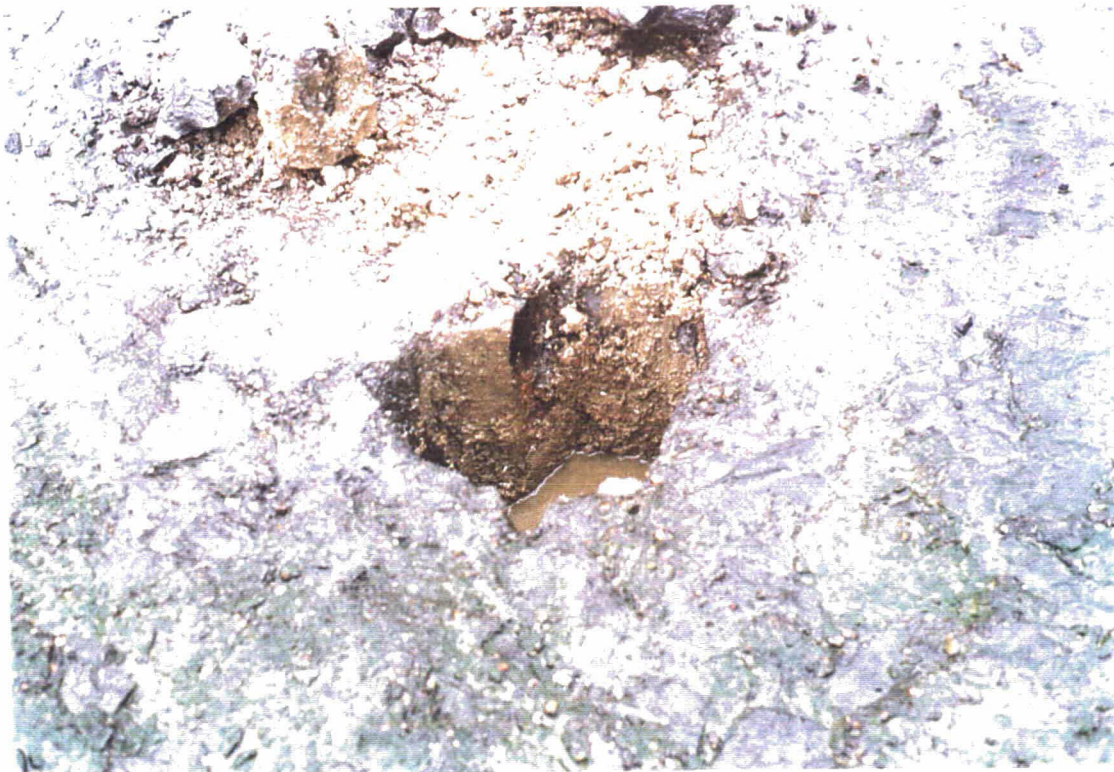
Foto 3 Gat bij km 30,75. Er is in ruime mate asfalt aanwezig, maar deze is niet al te diep tussen de spleten doorgedrongen. Het filter is duidelijk ingezand.
