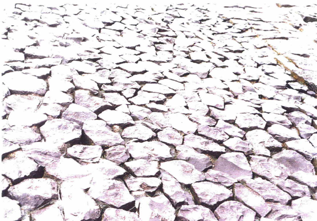
Foto 14 Lichte verzakking in het talud. De penetratie tussen de grotere gaten in de basalt lijkt deels uitgespoeld.
