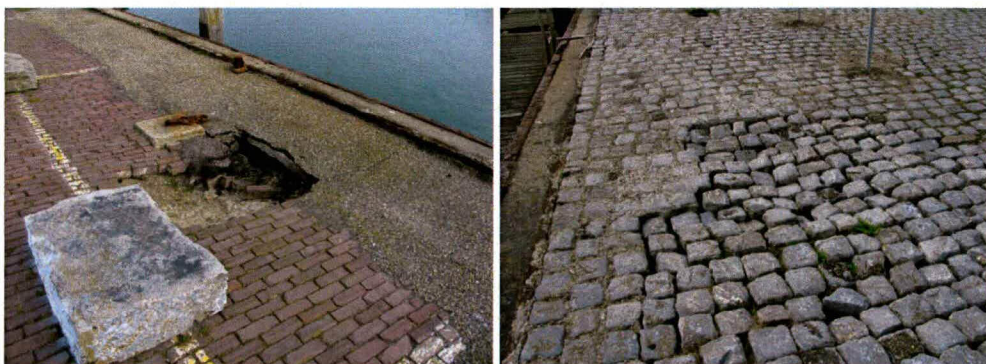
Figuur 2.5 Verzakkingen bestrating haventerrein
