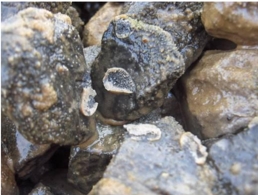
Afbeelding 6. Breuk ter plaatse van hechtingspunten tussen stenen.
