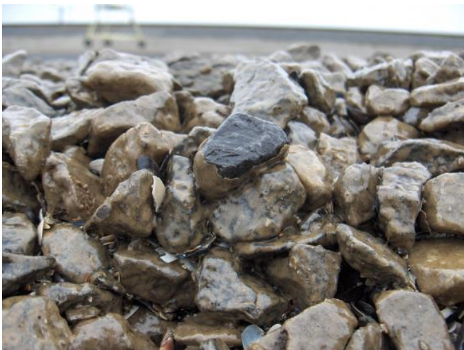
Afbeelding 2. Bij stripping is er onvoldoende hechting van de PU-lijm aan een nat oppervlak, waardoor de lijmlaag loslaat van de steen.
