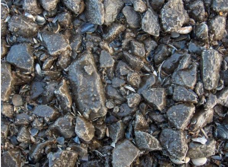
Abbeelding 7. Oppervlakkige slijtage van coating.
