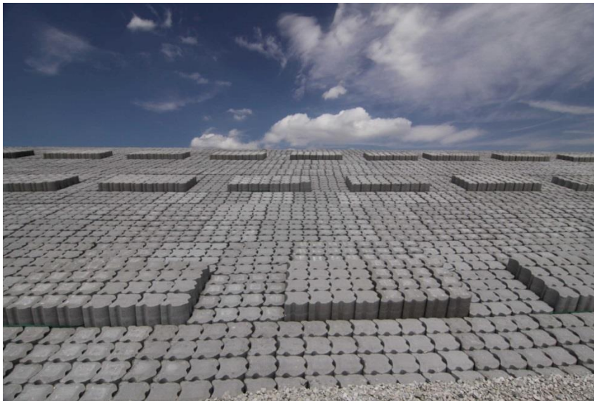
Figuur 3.1 Voorbeeld van een bijzonder patroon ten behoeve van de golfverslagreductie (Zoutelande, Zeeland)
