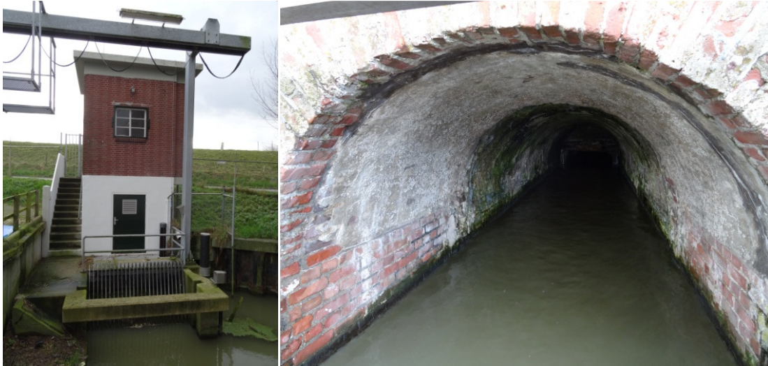
Afbeelding 3.9 Gemaal De Drie Polders (links) en de uitstroom van de pijpleiding in de jachthaven van Herkingen (rechts)
