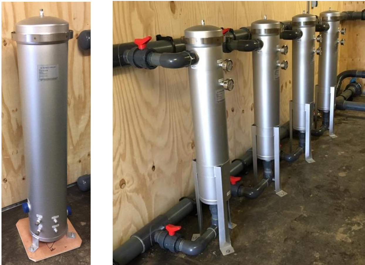
Figuur 2-15: De voorzuivering met het kaarsenfilter (links) en de vier voorgeschakelde zakkenfilters (rechts).
