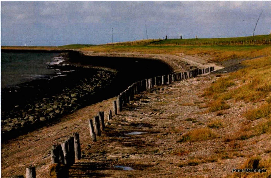
Oosterschelde bij Zuidhoekinlagen, Schouwen-Duiveland. Oude zeedijk met diverse bekledingstypen, perkoenpalen en zoutminnende planten. Foto: oktober 2012.
